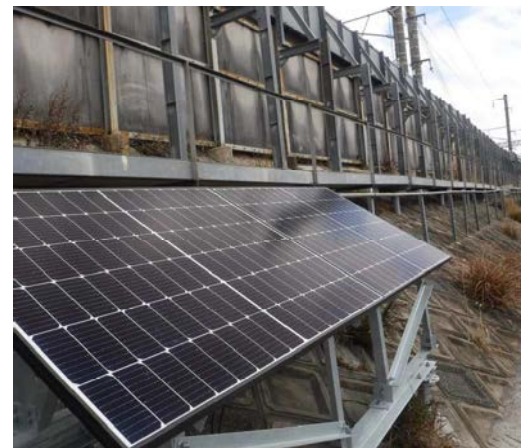
新幹線のり面を活用した太陽光発電(試験設置)
