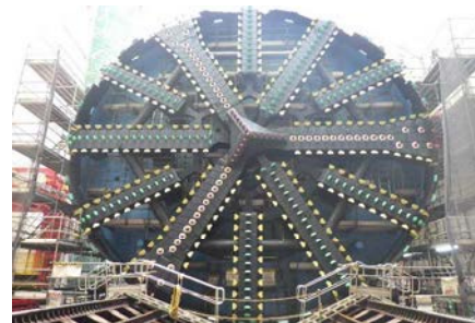
第一首都圏トンネル(梶ヶ谷工区) 掘進に向けて組み立て中のシールドマシン
