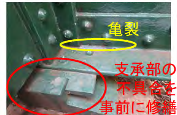
亀裂が発生した橋りょう
