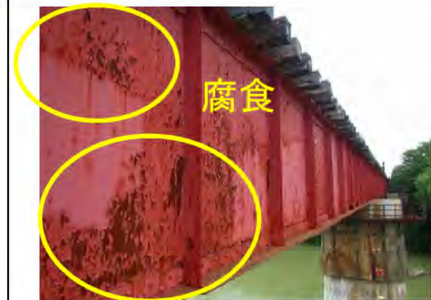
腐食が発生した橋りょう
