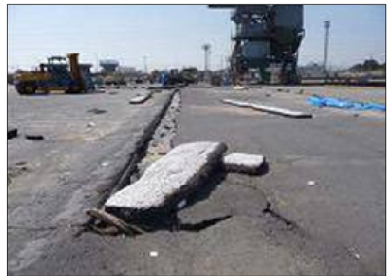
▲損壊した南公共ふ頭の荷捌き地
