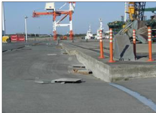
▲岸壁エプロン部に段差が生じた北公共ふ頭
