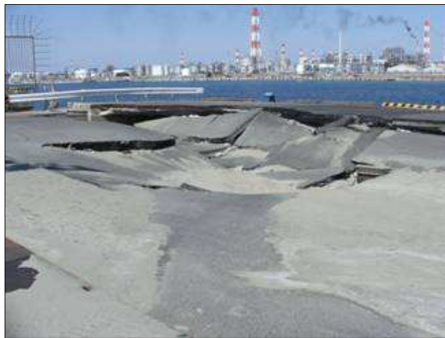
陥没した南公共ふ頭の荷捌き地
