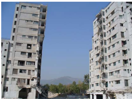
写真 3-31 高層マンションの倒壊
