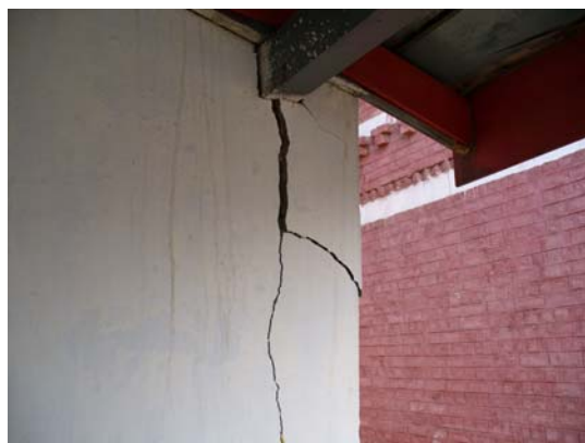
写真 3-24 レンガ造壁隅角部のひび割れ
