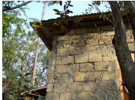
写真 3-28 壁隅角部のひび割れと上部 ブロックの脱落
