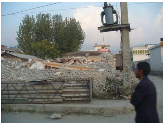
写真 3-29 倒壊した建物
