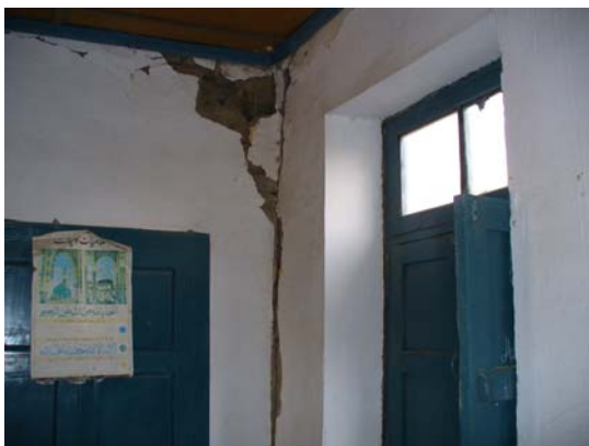
写真 3-17 州立小学校壁隅角部のひび割れ (教室)
