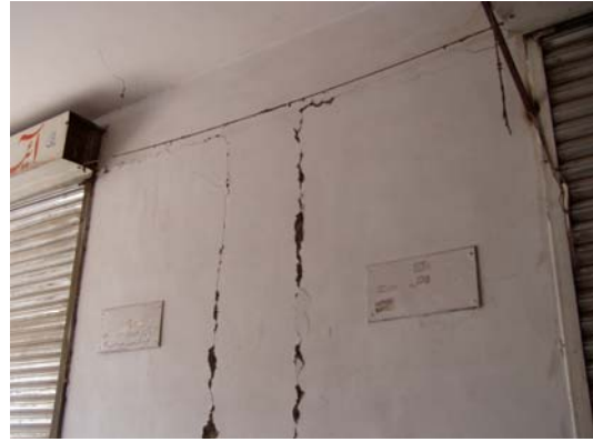
写真 3-7-2 同左の内部 構造材（柱、梁）と間仕切り壁との間にクラックが入っている
