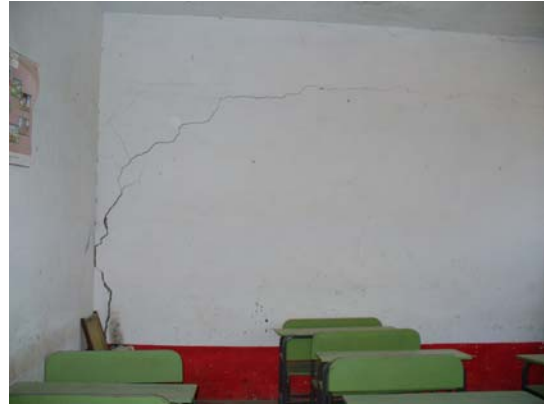
写真 3-16 州立小学校教室内のひび割れ
