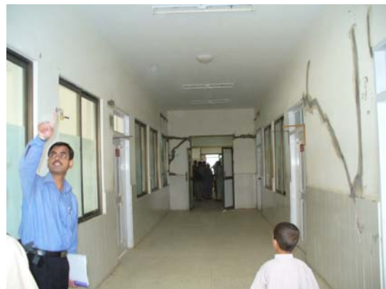
写真 3-14 病院新館1階廊下のひび割れ (ひび割れはモルタル等により補修してある)
