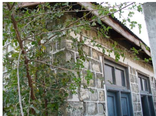
写真 3-18 州立小学校壁隅角部のひび割れ (外観)
