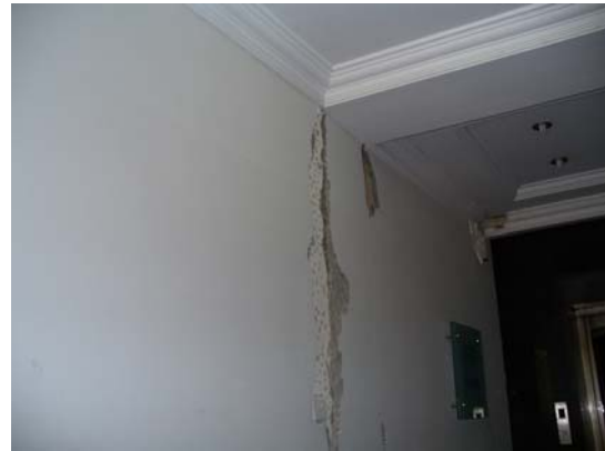
写真 3-36 事務所ビル1階柱とブロック壁の間のひび割れ
