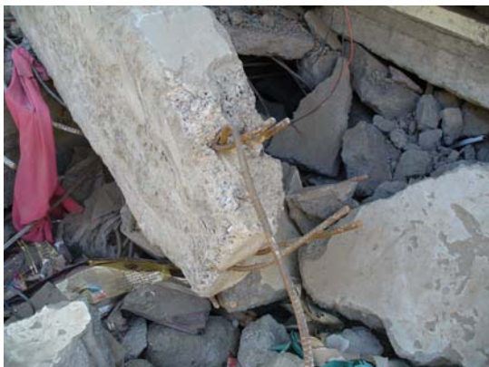
写真 3-5 倒壊した鉄筋コンクリート造 ホテルの詳細(写真 3-4 の詳細)
