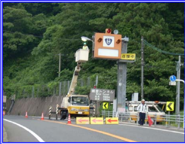
警報設備点検
