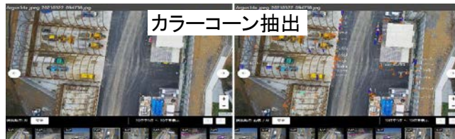
図-10 自動安全巡視 AI 変状比較
