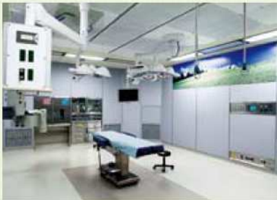
バイオクリーンルーム(手術室)
