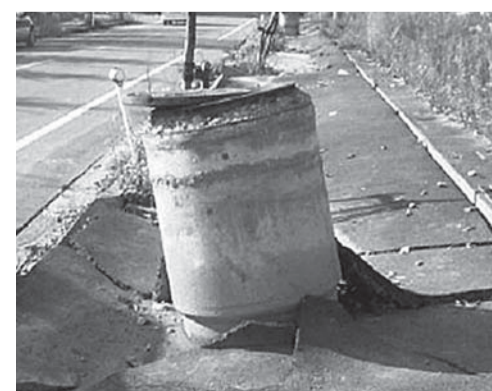
▲新潟県中越地震で浮上したマンホール
