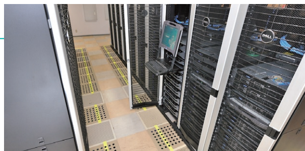
クラウドサーバ室
