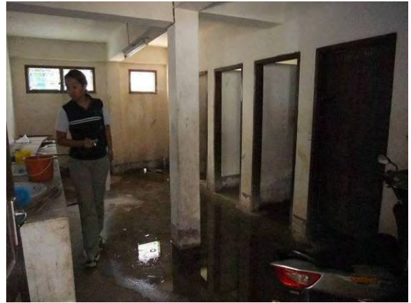
校内トイレ数 14。便器が汚れたままで床の水が排水されないなど不衛生。
