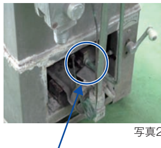
パイロットバーナー部分
