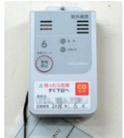
写真7-4 業務用換気警報器の設置事例
