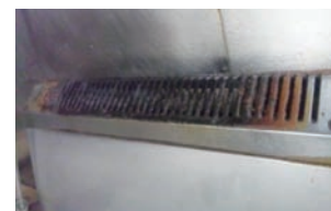
【激しい汚れの例(排気口部分)】
