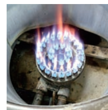
メインバーナーが腐食し、不完全燃焼した事例
