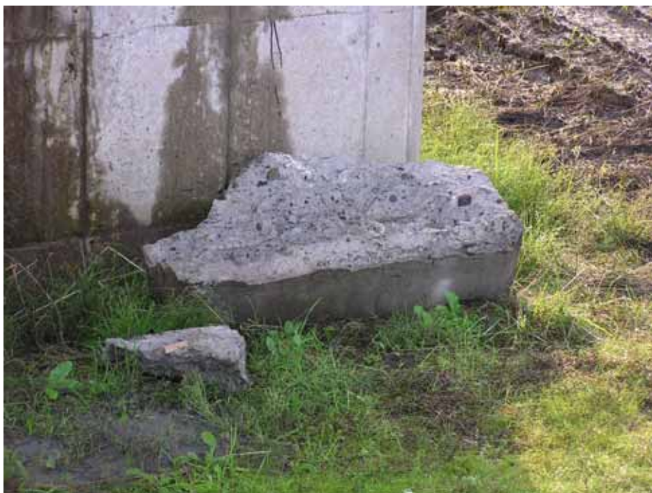
写真 - 2.8 上越新幹線高架橋 サイドブロックの損傷(2) (2004年11月7日)
