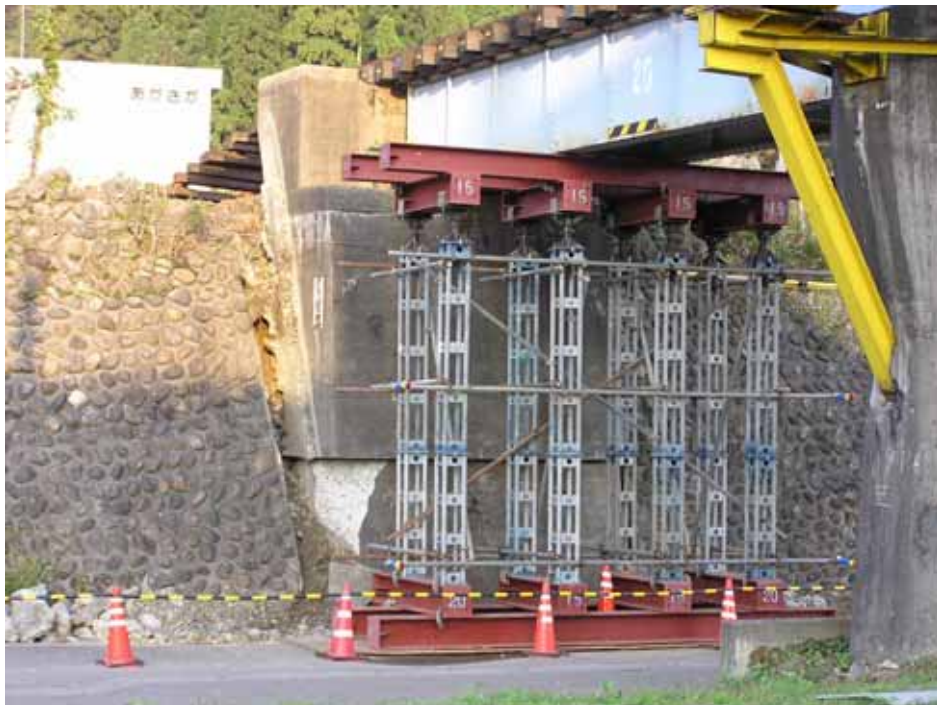
写真 - 2.40 魚野川橋梁の被害(4) (2004年11月7日)
