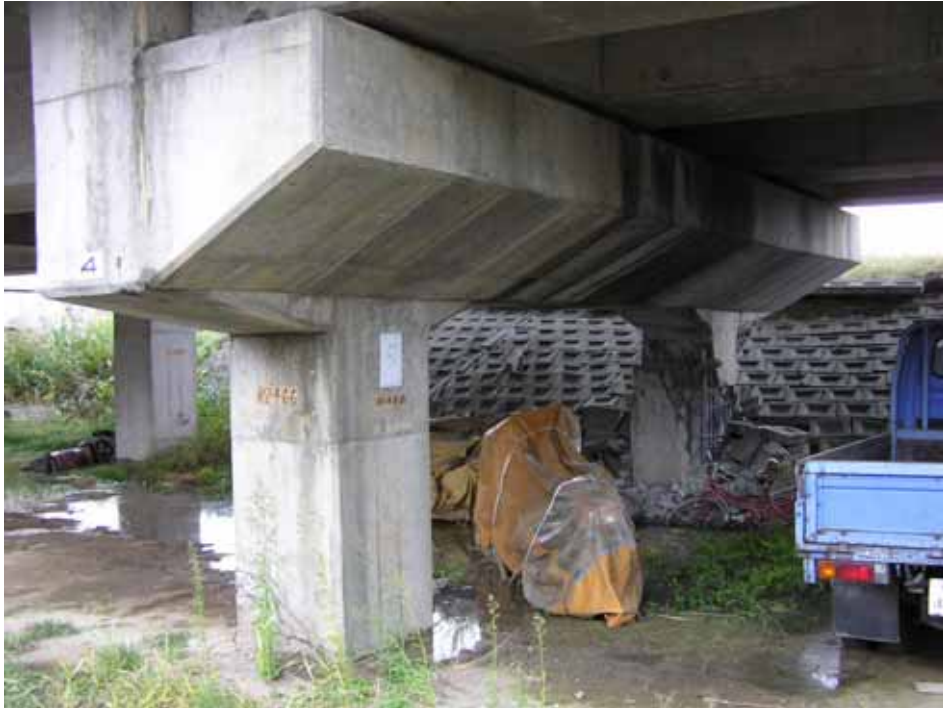
写真 - 2.53 高架橋の損傷(3) (2004年10月25日)
