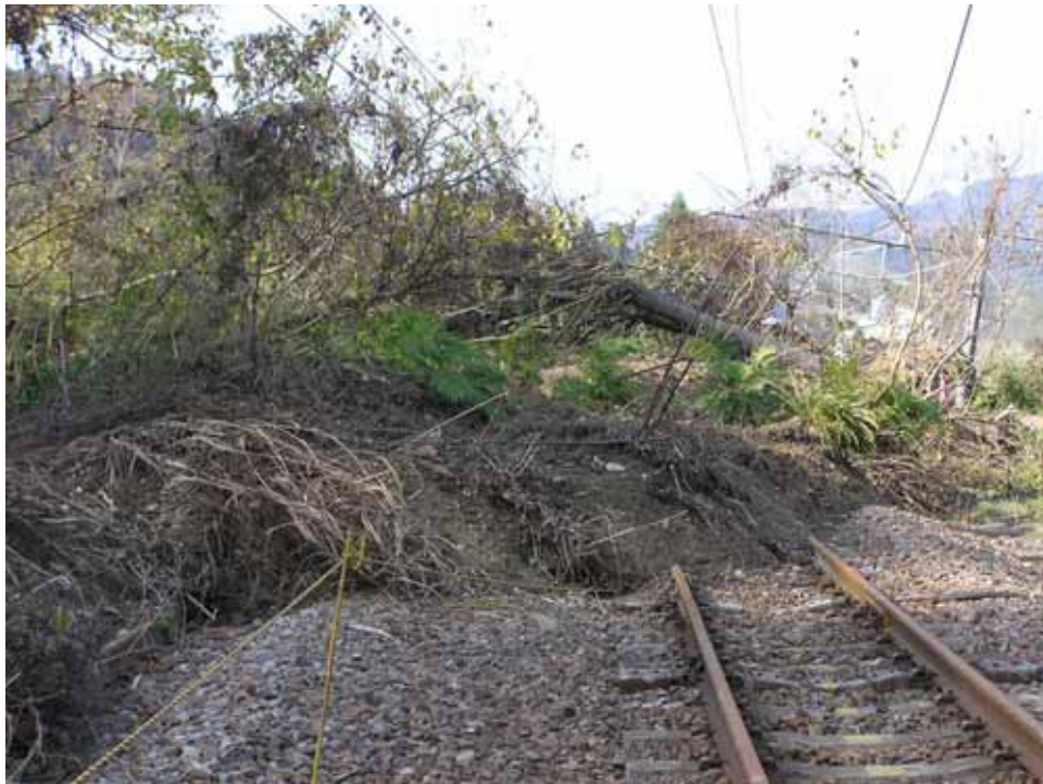
写真 - 2.84 斜面崩壊(2) (2004年11月6日)
