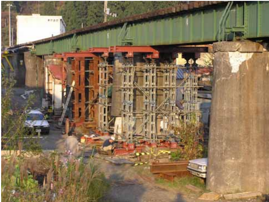
写真 - 2.37 魚野川橋梁の被害(1) (2004年11月7日)
