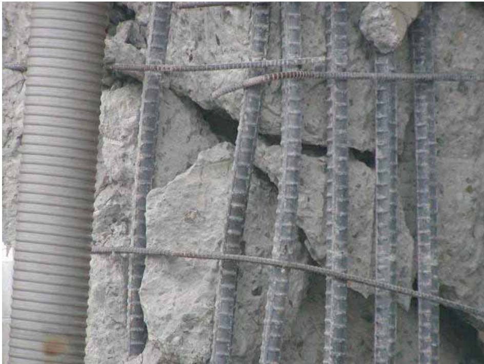
写真 - 2.58 高架橋の損傷(8) (2004年10月25日)
