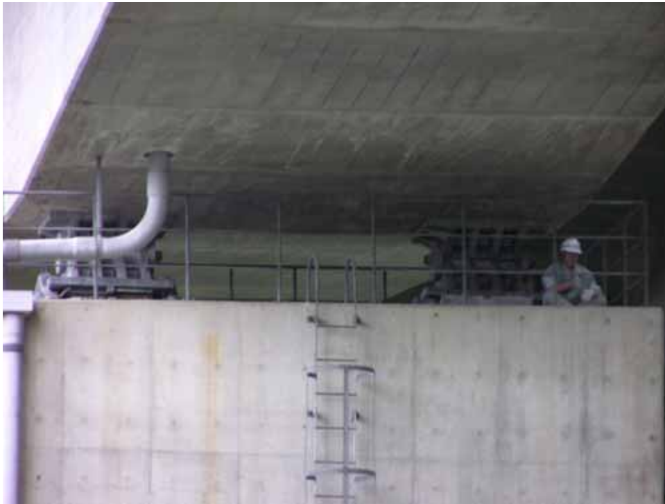
写真 - 2.93 支承部の損傷 (2004年10月25日)
