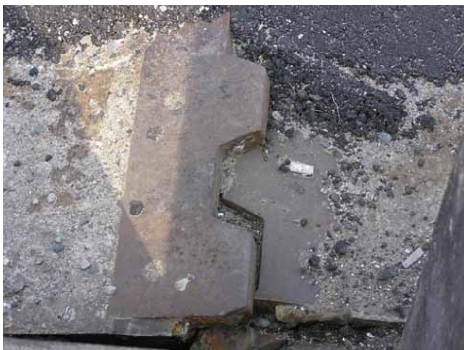
写真 - 2.46 伸縮装置の損傷 (2004年11月6日)
