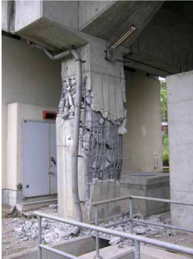
写真 - 2.57 高架橋の損傷(7) (2004年10月25日)
