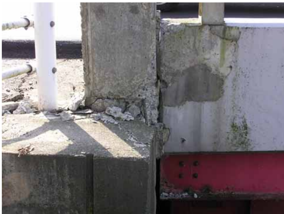
写真 - 2.45 橋台部の損傷(2) (2004年11月6日)
