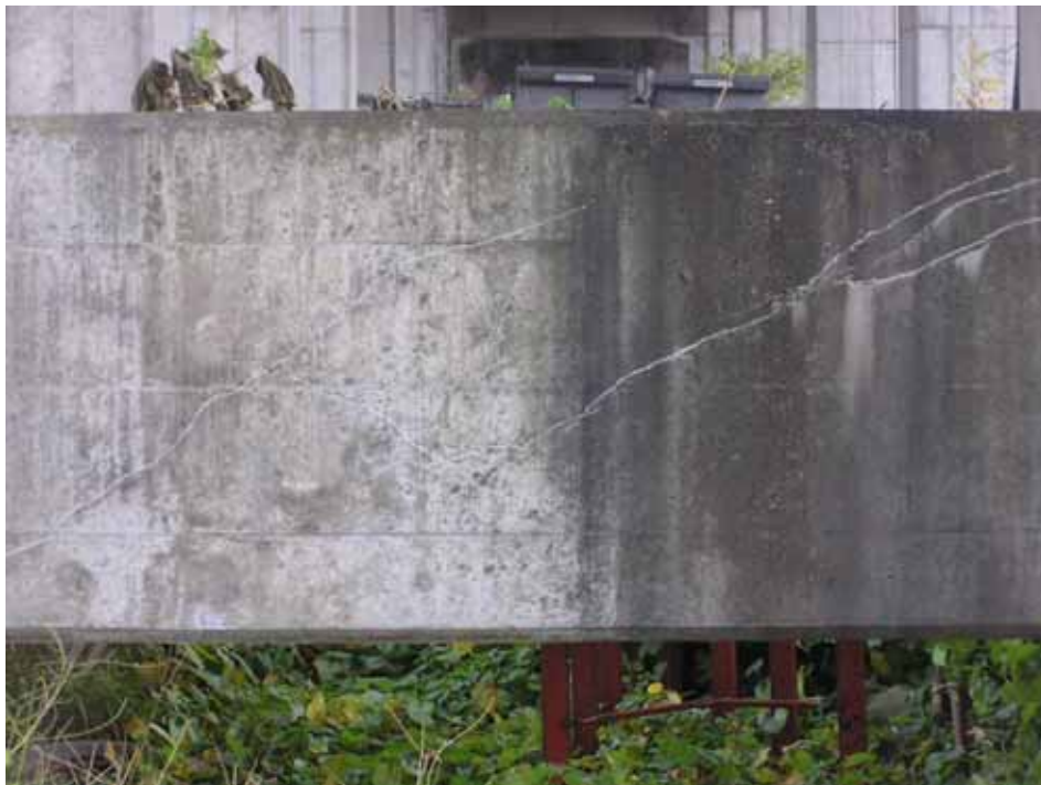
写真 - 2.50 中層梁の損傷(3) (2004年11月6日)
