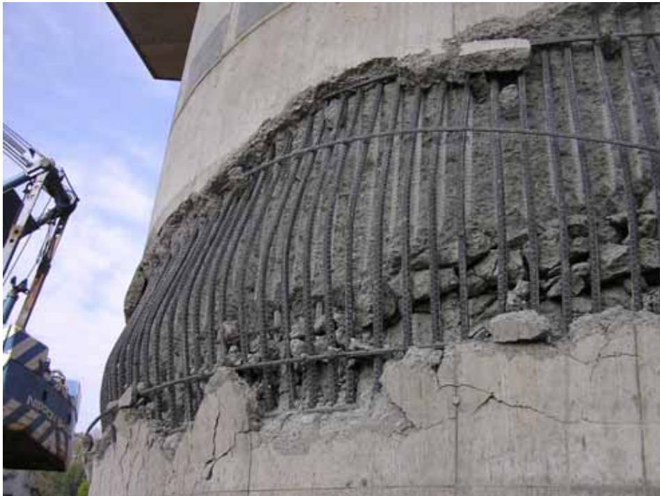
写真 - 2.72 魚野川橋梁の被害(6) (2004年11月6日)
