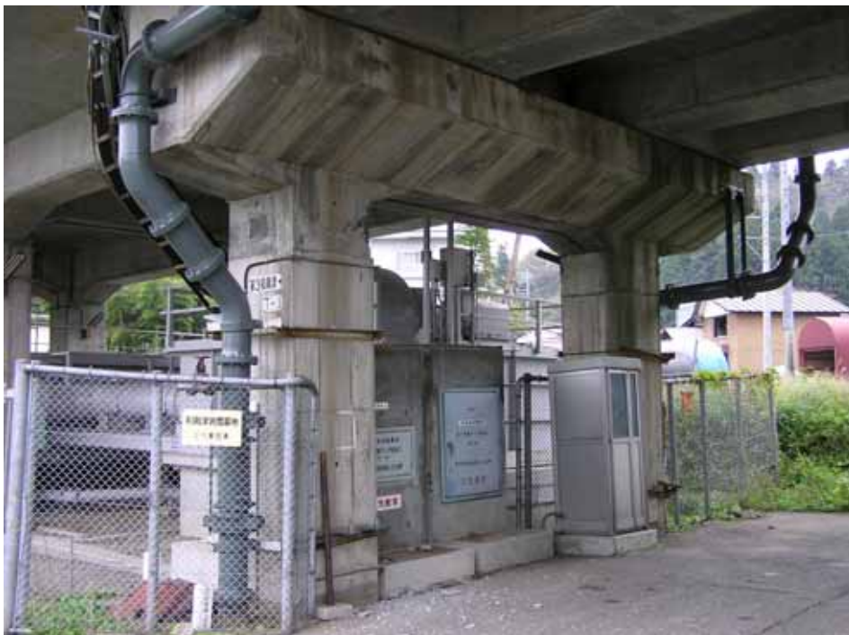
写真 - 2.55 高架橋の損傷(5) (2004年10月25日)
