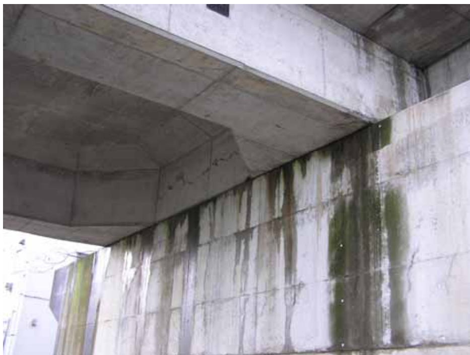
写真 - 2.5 上越新幹線高架橋 桁端部の損傷（2004年11月7日）
