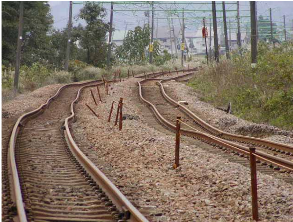
写真 - 2.81 地盤変状(1) (2004 年 10 月 25 日)
