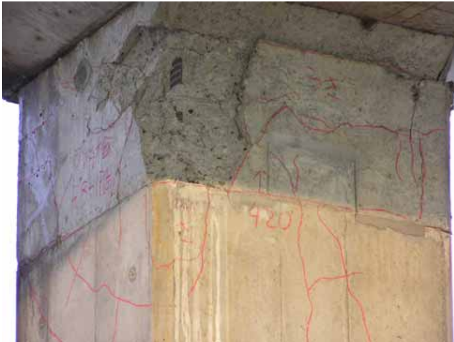
写真 - 2.1 上越新幹線高架橋 柱の損傷(1) (2004年11月7日)
