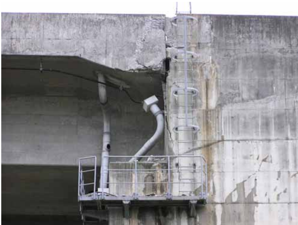
写真 - 2.92 橋台部の損傷(2) (2004年10月25日)
