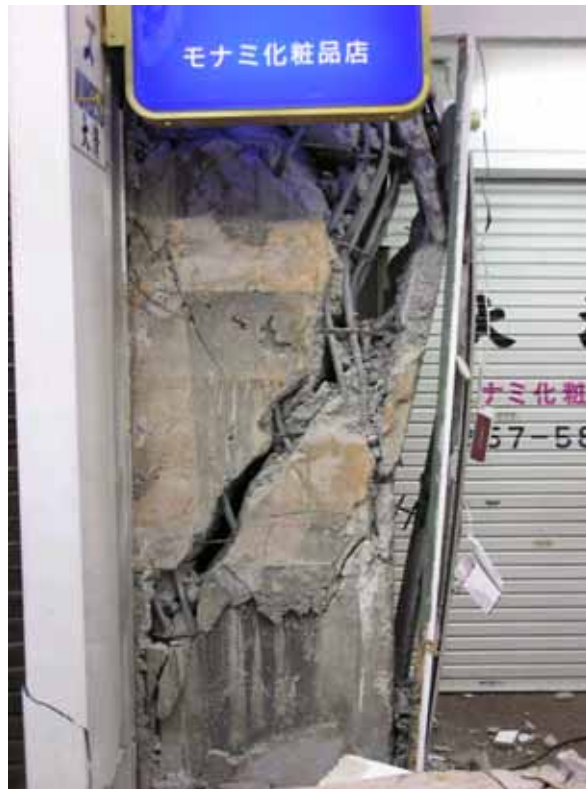
写真 - 2.117 建物1階の柱の損傷(1) (2004年10月25日)
