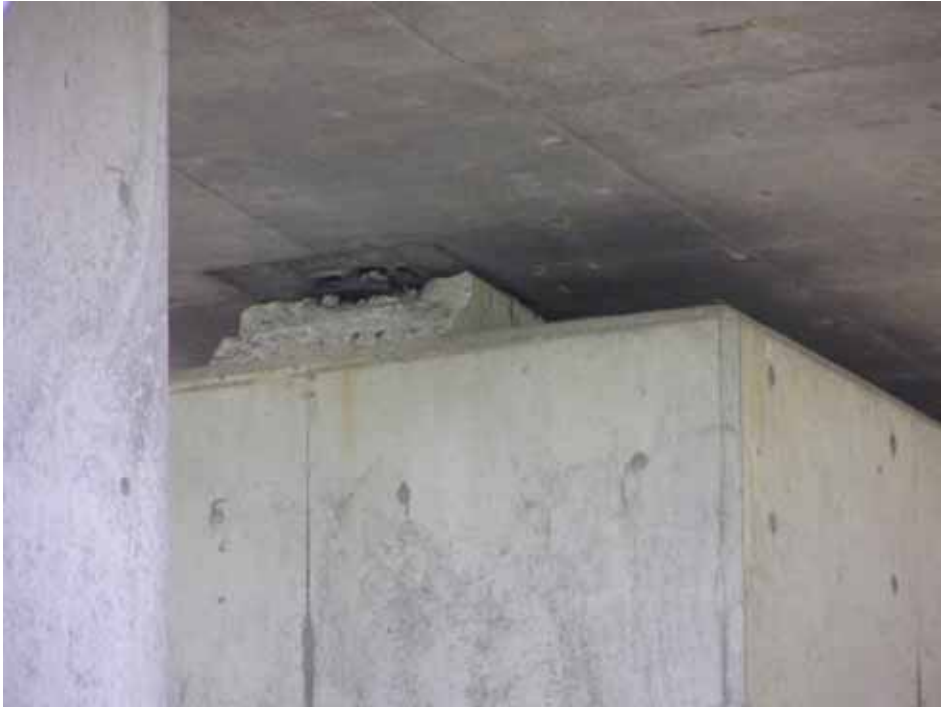
写真 - 2.13 支承部の損傷(3) (2004年11月7日)
