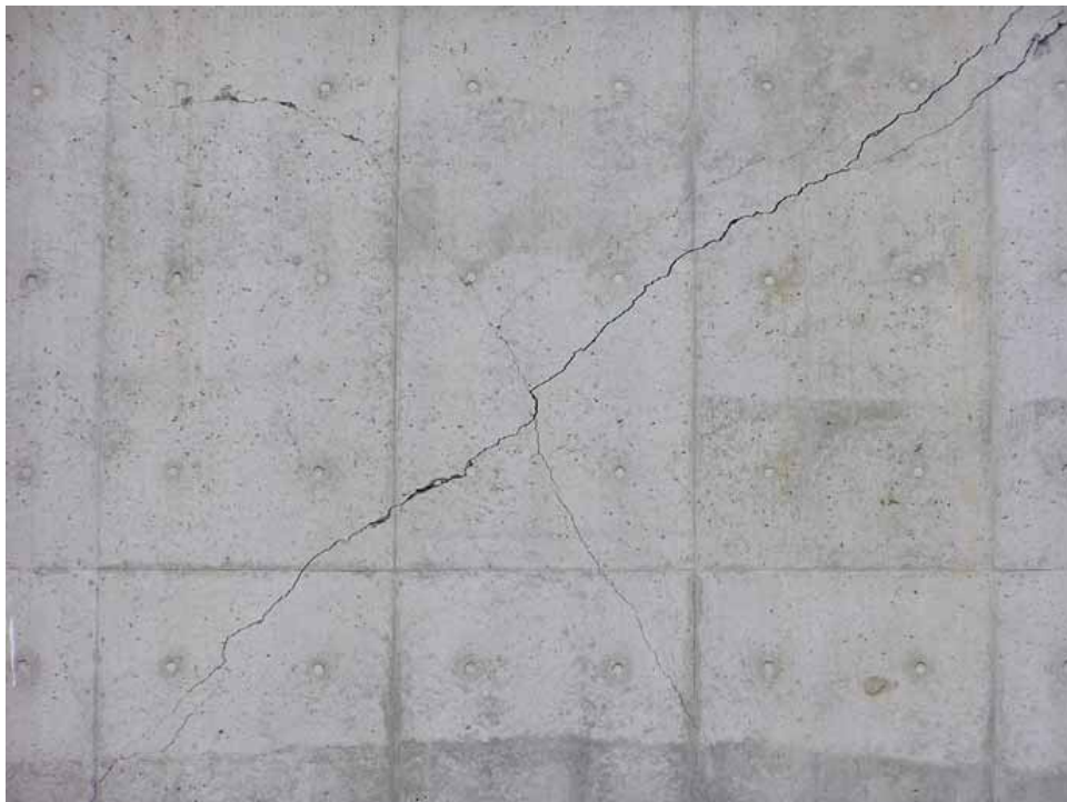
写真 - 2.90 橋脚の損傷(3) (2004年10月25日)
