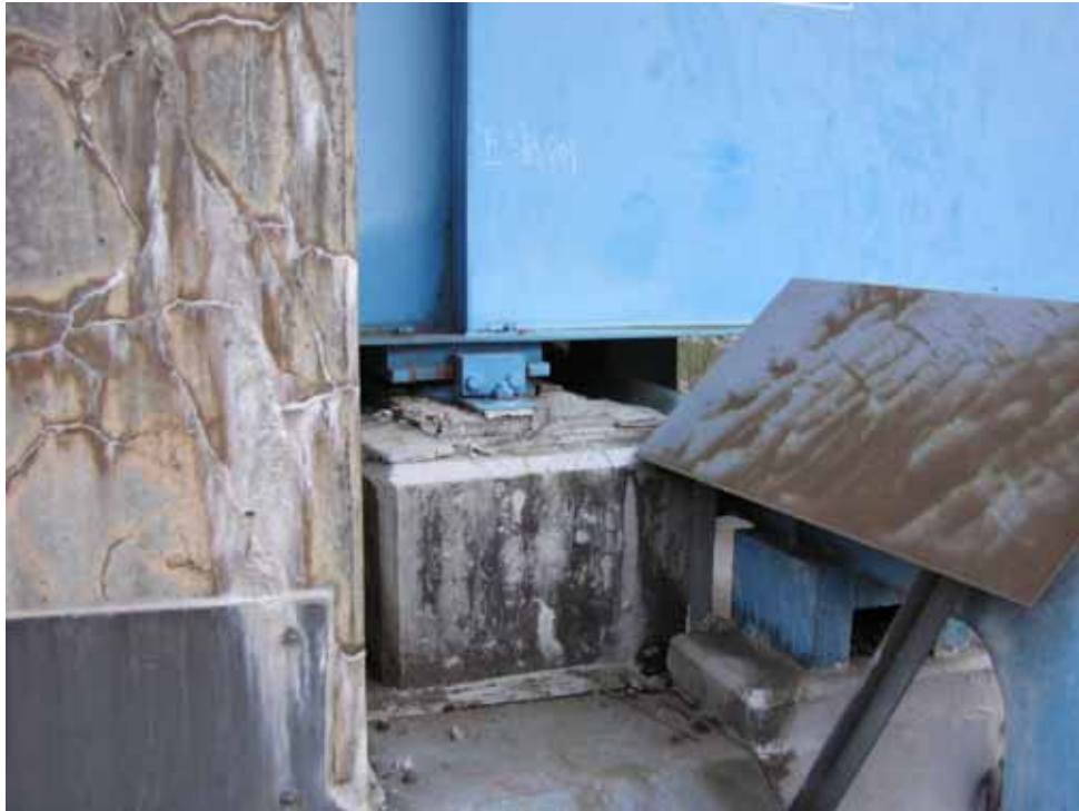
写真 - 2.101 支承部の損傷(1) (2004年11月6日)
