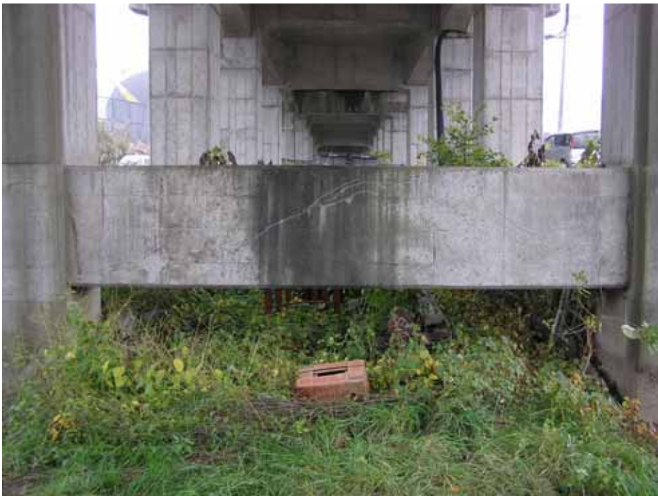
写真 - 2.48 中層梁の損傷(1) (2004年11月6日)
