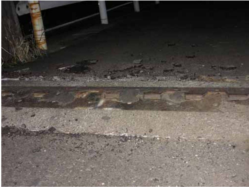
写真 - 2.105 伸縮装置の損傷(1) (2004年11月6日)
