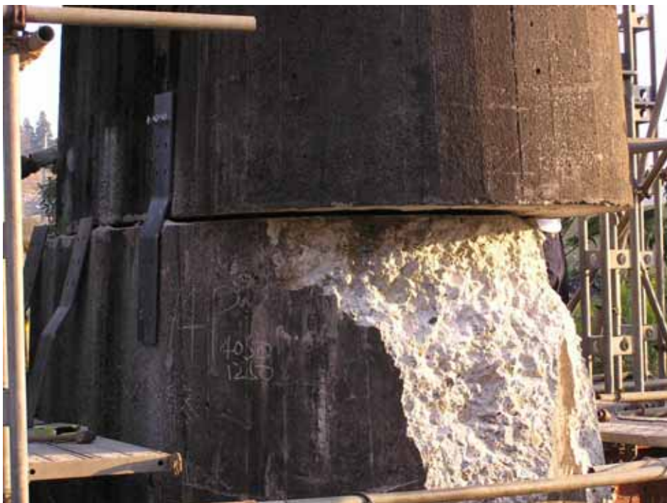
写真 - 2.38 魚野川橋梁の被害(2) (2004年11月7日)
