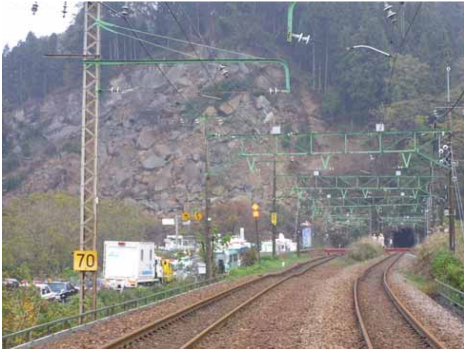
写真 - 2.23 榎トンネルの被災状況(3) (2004年11月7日)
