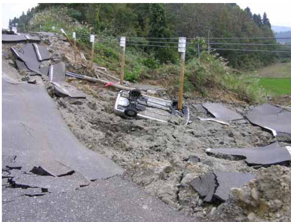
写真 - 2.110 道路陥没(2) (2004 年 10 月 25 日)
