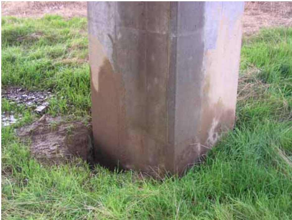
写真 - 2.4 上越新幹線高架橋 柱下端部の液状化 (2004年11月7日)
