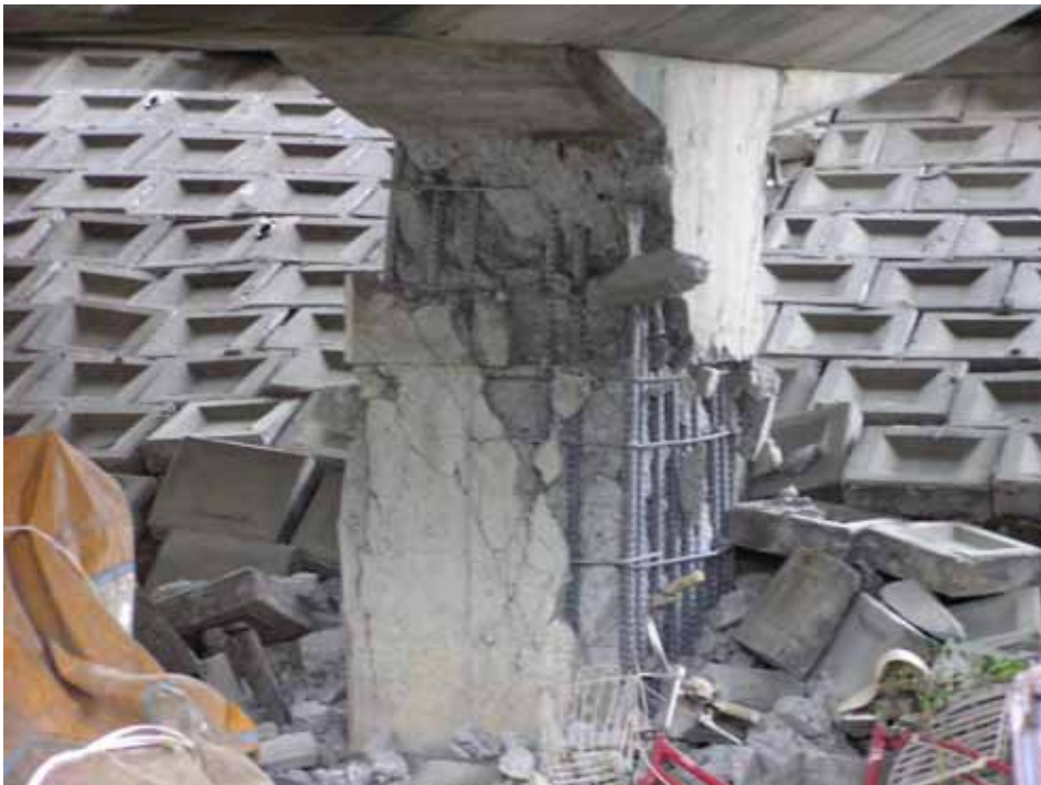
写真 - 2.54 高架橋の損傷(4) (2004年10月25日)
