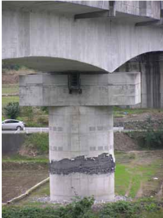
写真 - 2.69 魚野川橋梁の被害(3) (2004年10月25日)
