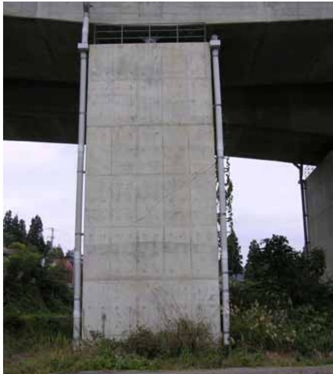
写真 - 2.88 橋脚の損傷(1) ( 2004 年 10 月 25 日 )
