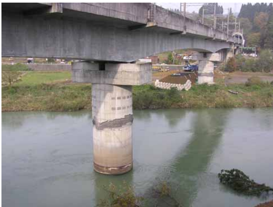
写真 - 2.68 魚野川橋梁の被害(2) (2004年11月6日)
