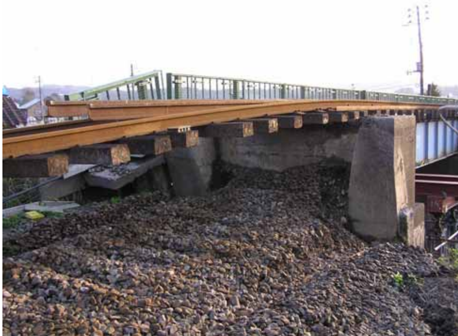
写真 - 2.41 魚野川橋梁橋台背面土の沈下 (2004年11月7日)
