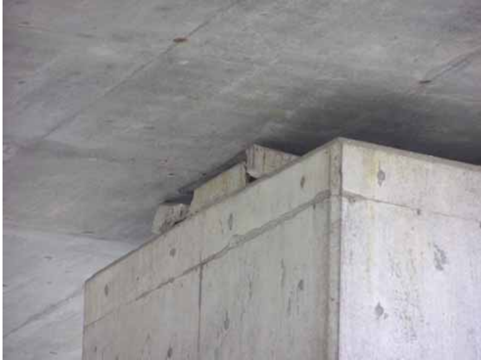
写真 - 2.15 支承部の損傷(5) (2004年11月7日)
