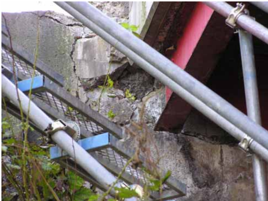
写真 - 2.44 橋台部の損傷(1) (2004 年 11 月 6 日)
