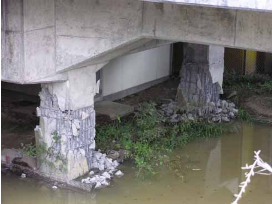
写真 - 2.51 高架橋の損傷(1) (2004年10月25日)
