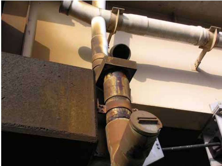
写真 - 2.16 配水管のずれ (2004年11月7日)
