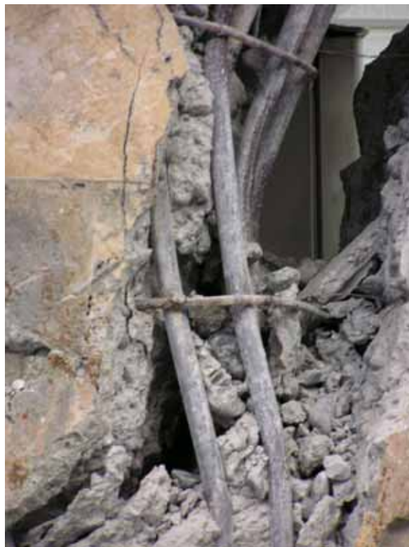
写真 - 2.118 建物1階の柱の損傷(2) (2004年10月25日)
