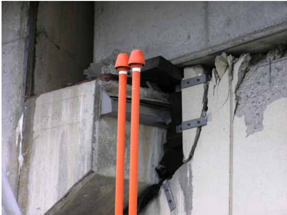
写真 - 2.60 高架橋の損傷(10) (2004年10月25日)
