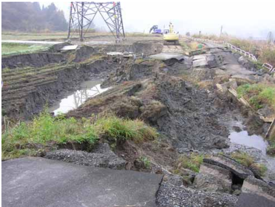
写真 - 2.76 斜面崩壊(4) (2004年11月6日)
