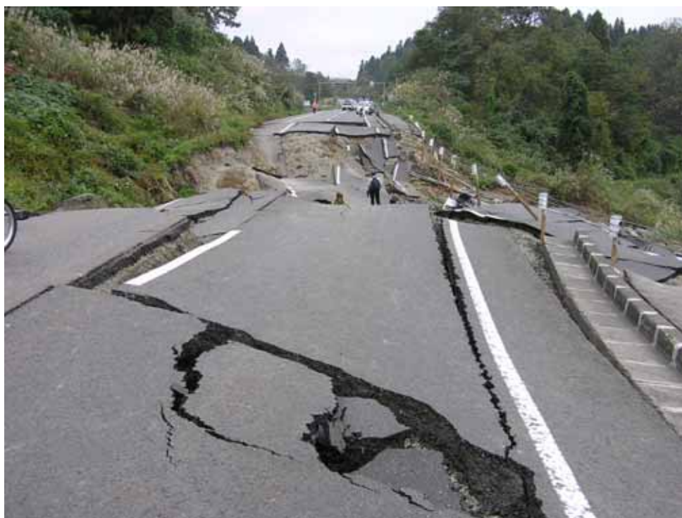
写真 - 2.109 道路陥没(1) (2004 年 10 月 25 日)
