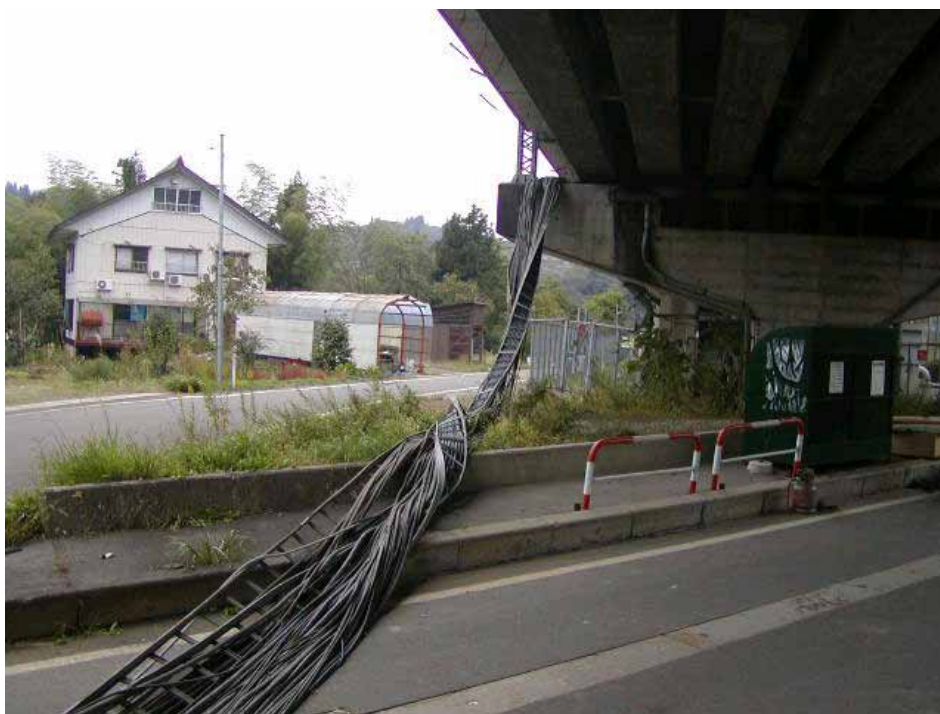
写真 - 2.62 高架橋の損傷(12) (2004年10月25日)
