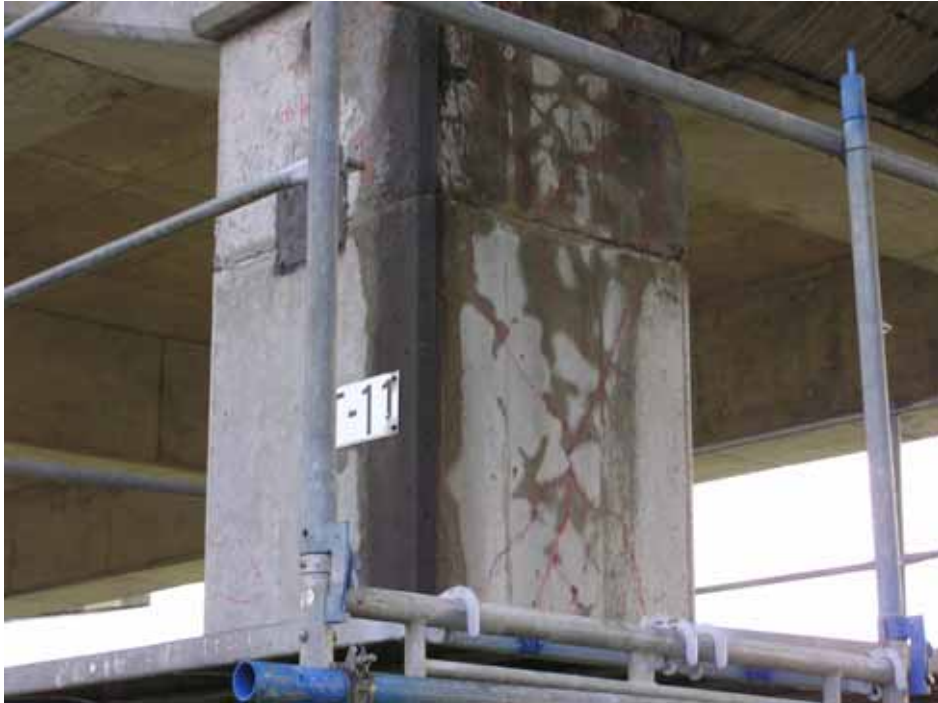
写真 - 2.3 上越新幹線高架橋 柱の損傷(3) (2004年11月7日)
