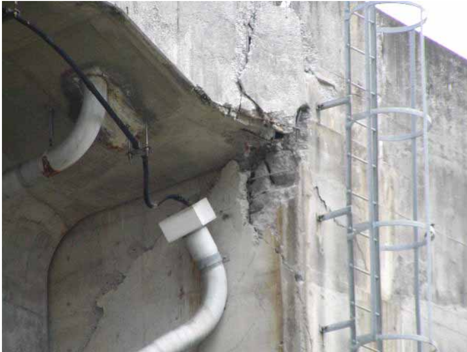
写真 - 2.91 橋台部の損傷(1) (2004年10月25日)
