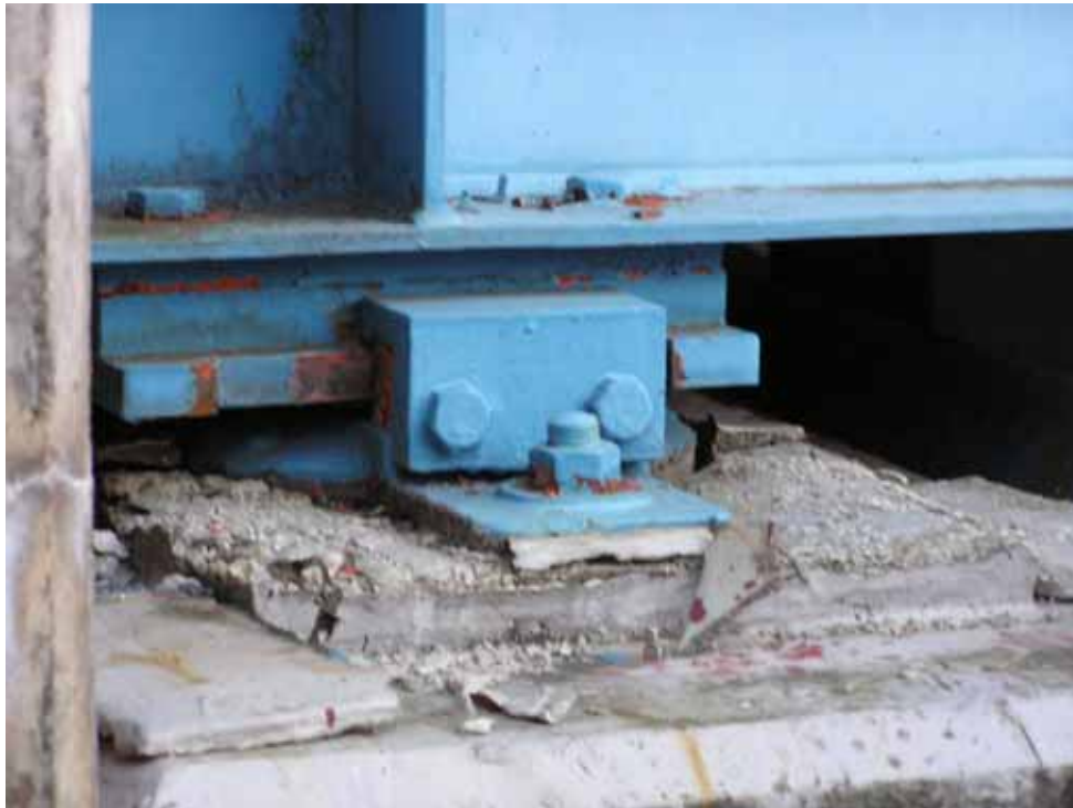
写真 - 2.102 支承部の損傷(2) (2004年11月6日)
