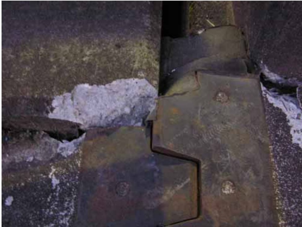
写真 - 2.106 伸縮装置の損傷(2) (2004年11月6日)
