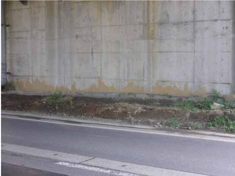
写真 - 2.31 橋脚下端の液状化跡（2004年11月7日）
