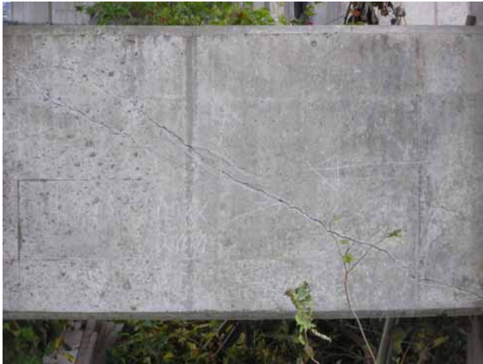
写真 - 2.49 中層梁の損傷(2) (2004年11月6日)
