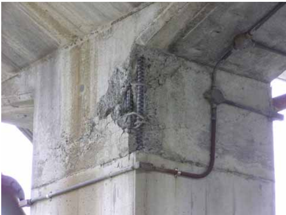
写真 - 2.56 高架橋の損傷(6) (2004年10月25日)
