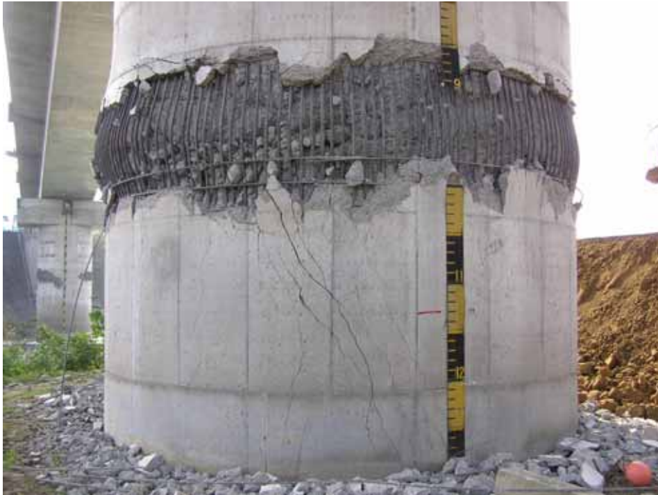
写真 - 2.71 魚野川橋梁の被害(5) (2004年11月6日)
