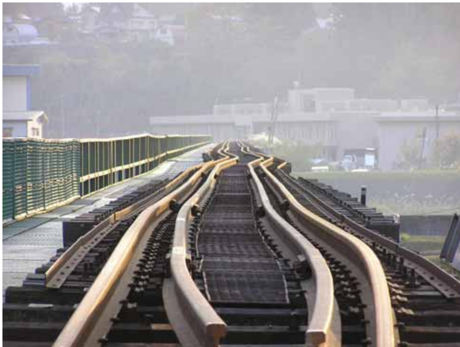
写真 - 2.42 レールの変形 (橋梁部) (2004年11月7日)
