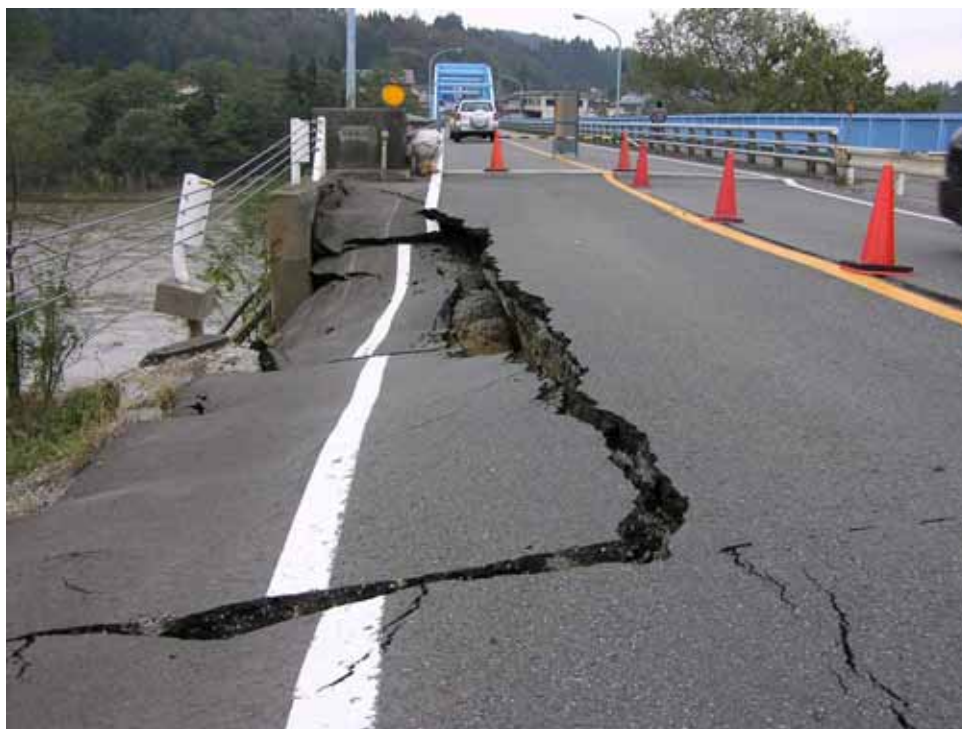
写真 - 2.100 橋台背面土の沈下 (2004 年 10 月 25 日)
