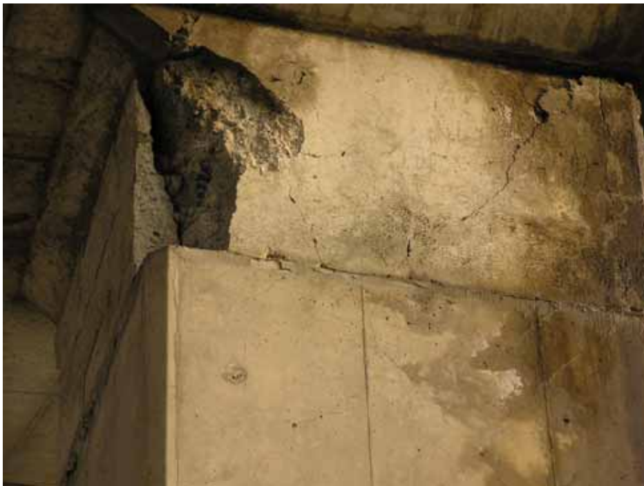
写真 - 2.2 上越新幹線高架橋 柱の損傷(2) (2004年11月7日)
