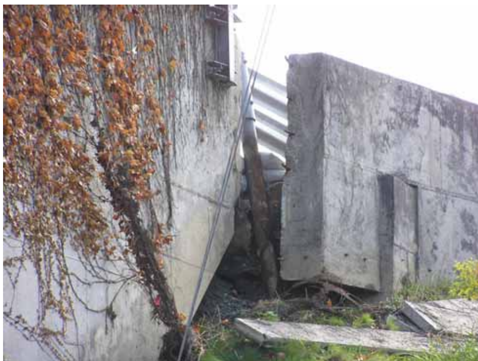
写真 - 2.30 橋台背面土のずれ (2004 年 11 月 7 日)
