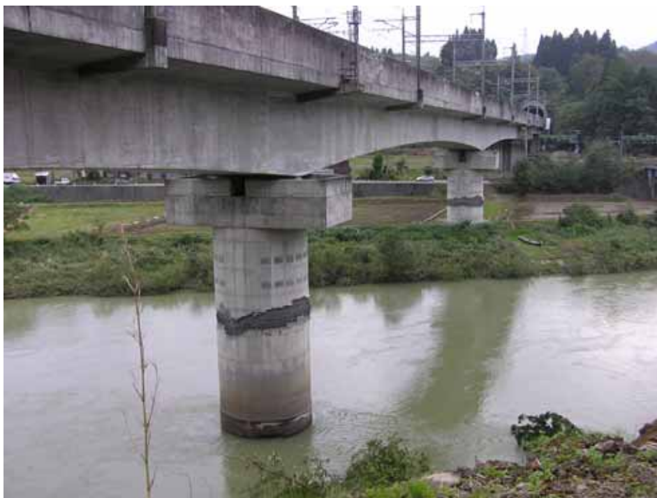
写真 - 2.67 魚野川橋梁の被害(1) (2004年10月25日)
