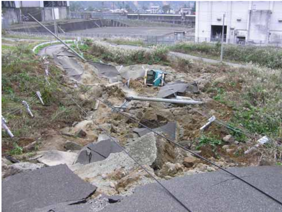
写真 - 2.73 斜面崩壊(1) (2004年10月25日)
