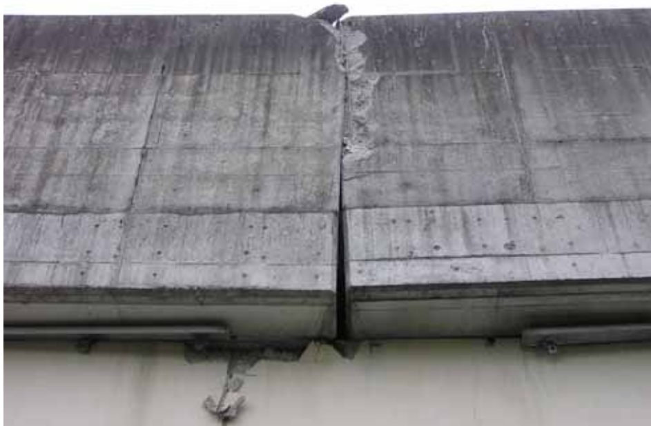
写真 - 2.61 高架橋の損傷(11) (2004年10月25日)
