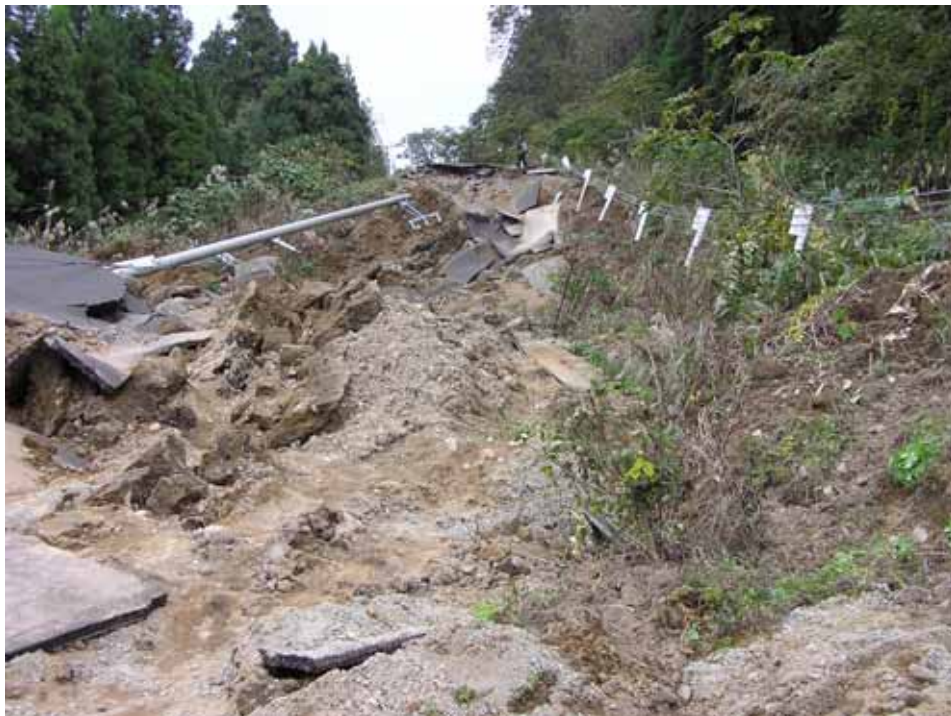
写真 - 2.74 斜面崩壊(2) (2004年10月25日)
