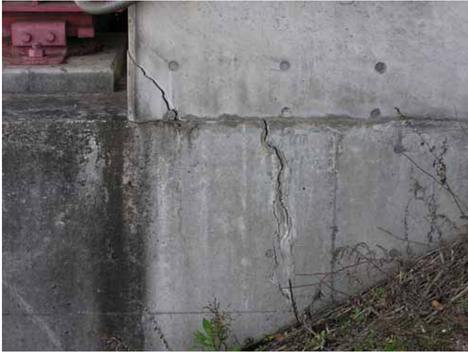
写真 - 2.85 橋台部の損傷(1) ( 2004 年 11 月 6 日 )
