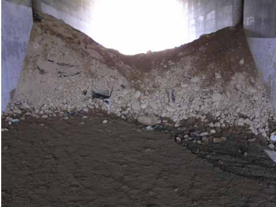
写真 - 2.35 ボックスカルパート部の被害(3) (2004年11月7日)
