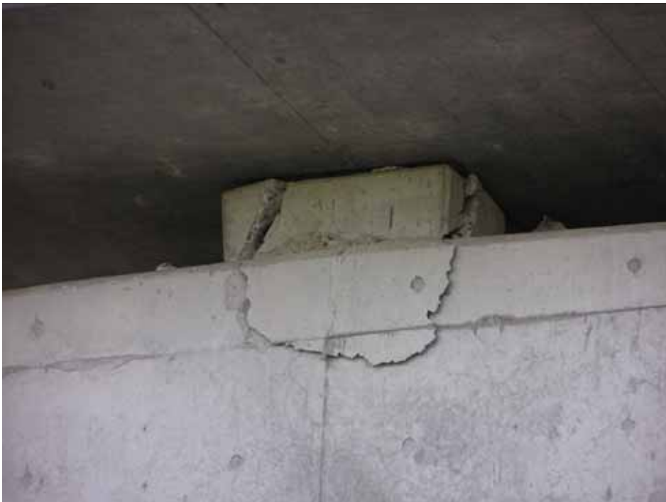
写真 - 2.12 支承部の損傷(2) (2004 年 11 月 7 日)
