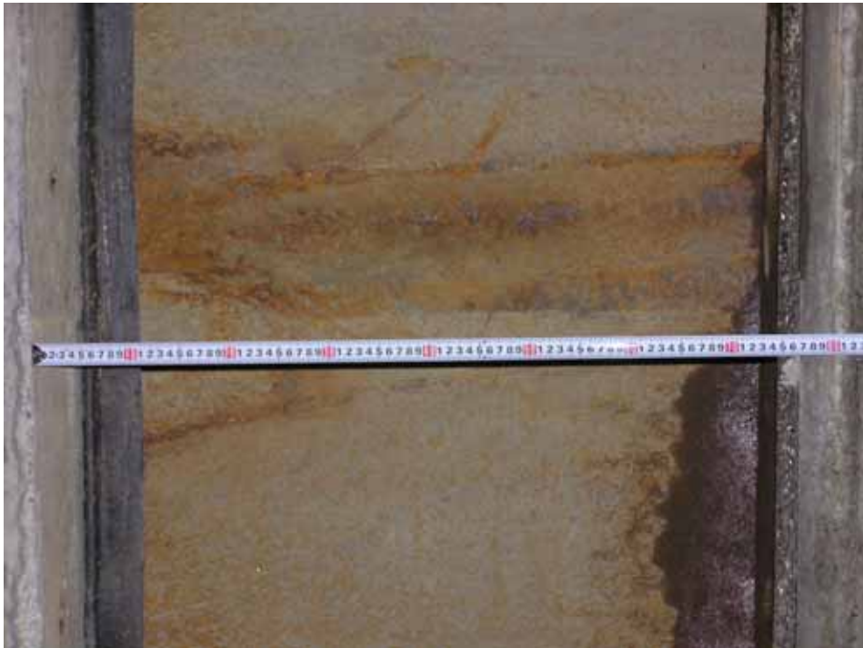
写真 - 2.36 ボックスカルパート部の被害(4) (2004年11月7日)
