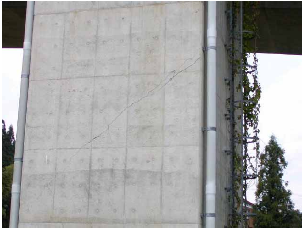
写真 - 2.89 橋脚の損傷(2) (2004年10月25日)
