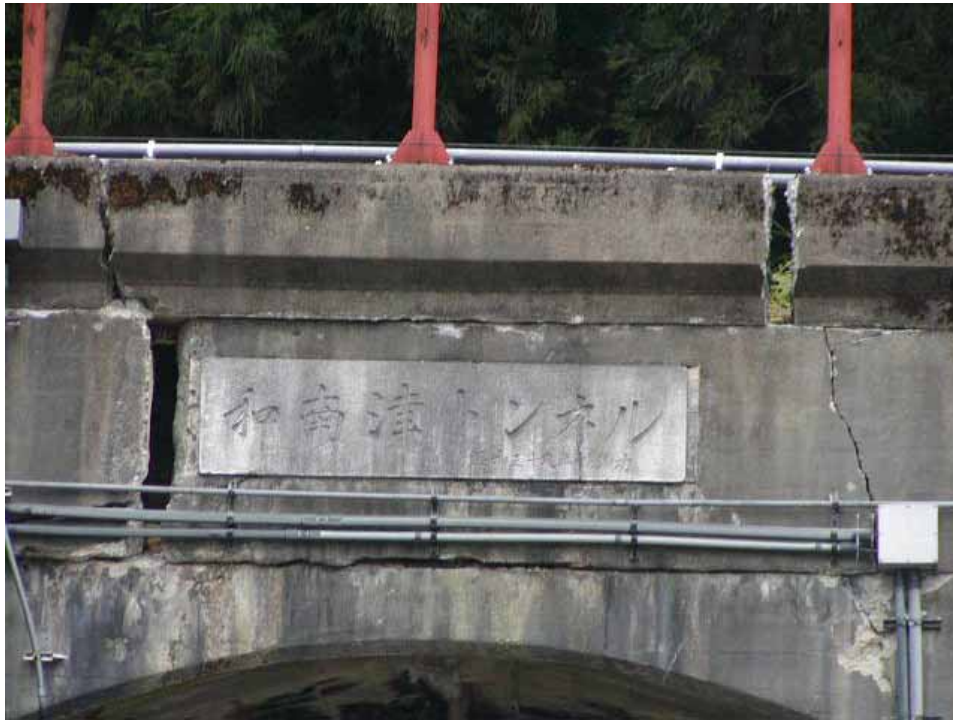
写真 - 2.79 和南津トンネルの被害(3) (2004年10月25日)
