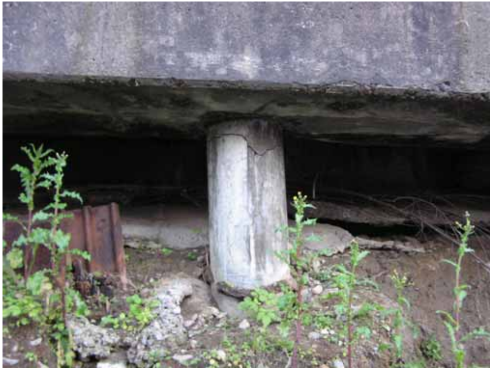
写真 - 2.103 背面土部支持杭の損傷(1) (2004年11月6日)
