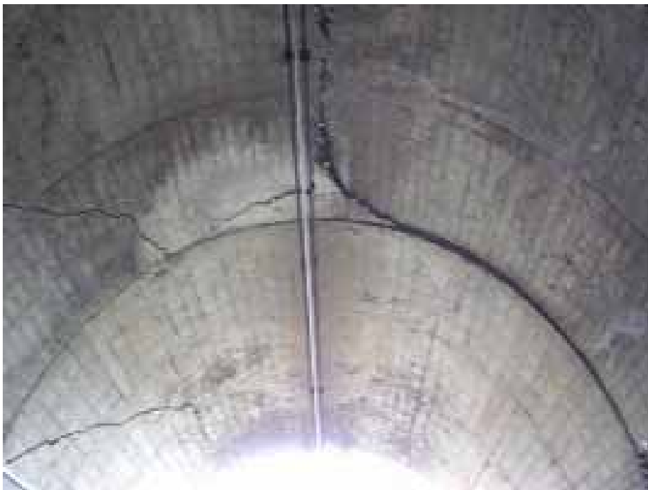
写真 - 2.22 榎トンネルの被災状況(2) (2004年10月25日)
