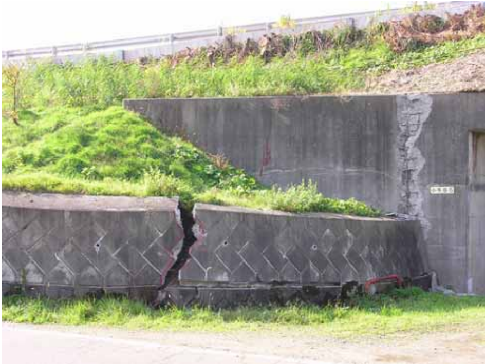
写真 - 2.33 ボックスカルバート部の被害(1) (2004年11月7日)
