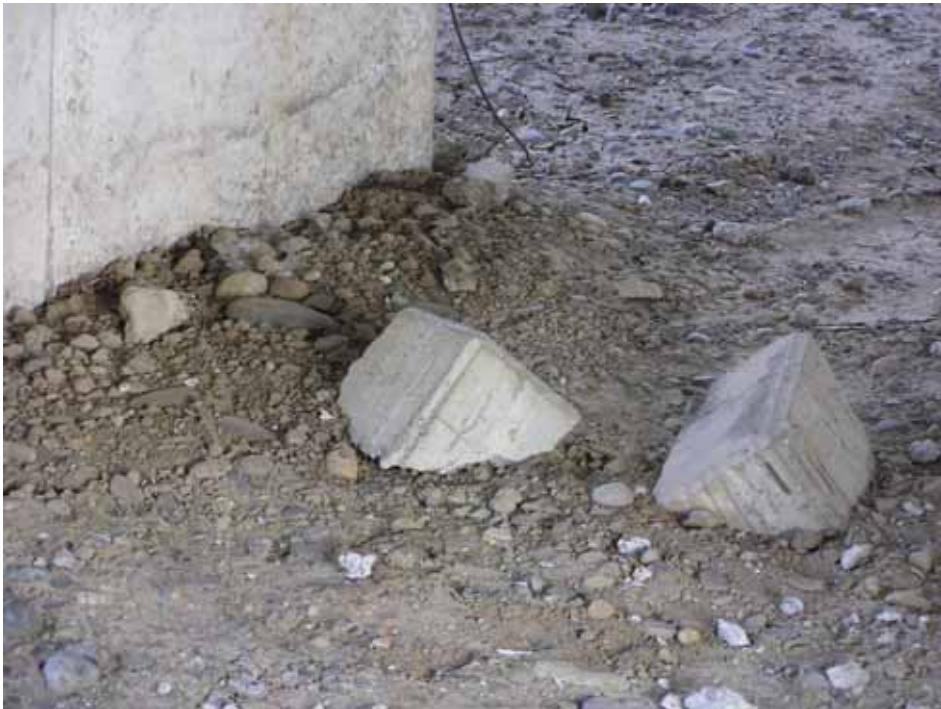
写真 - 2.14 支承部の損傷(4) (2004年11月7日)
