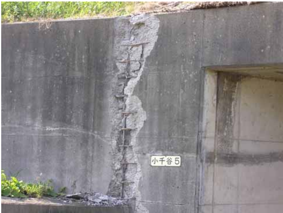
写真 - 2.34 ボックスカルバート部の被害(2) (2004年11月7日)
