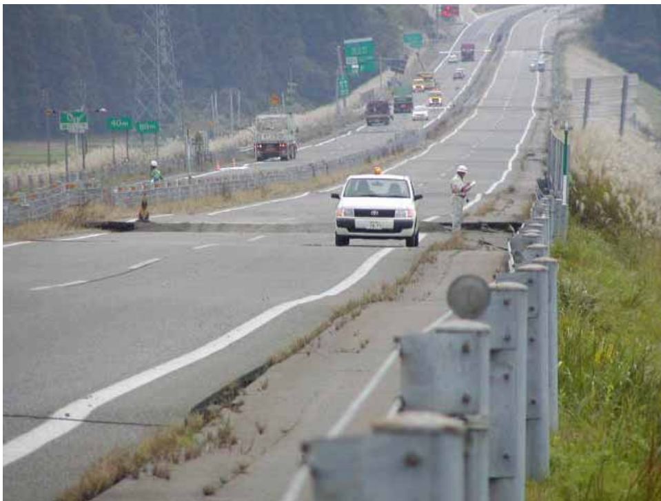
写真 - 2.94 路面の状況 (2004年10月25日)
