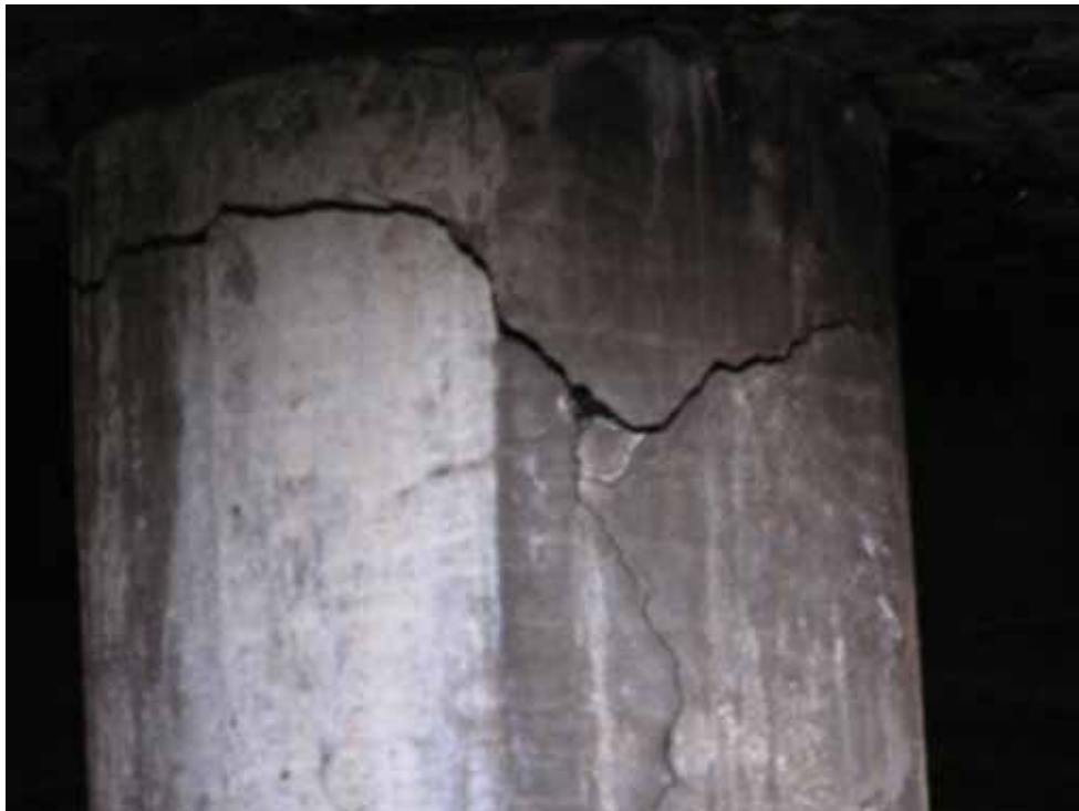
写真 - 2.104 背面土部支持杭の損傷(2) (2004年11月6日)
