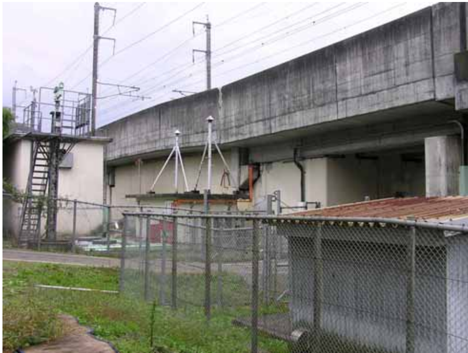
写真 - 2.59 高架橋の損傷(9) (2004年10月25日)
