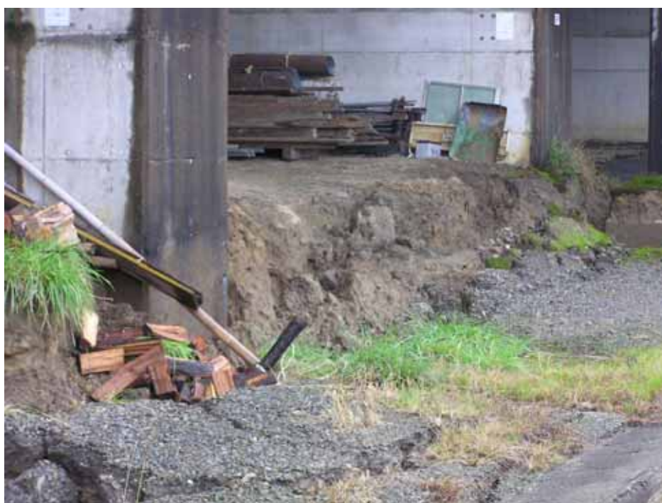
写真 - 2.6 上越新幹線高架橋 周辺地盤の被害（2004年11月7日）
