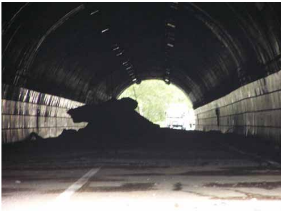
写真 - 2.78 和南津トンネルの被害(2) (2004年10月25日)
