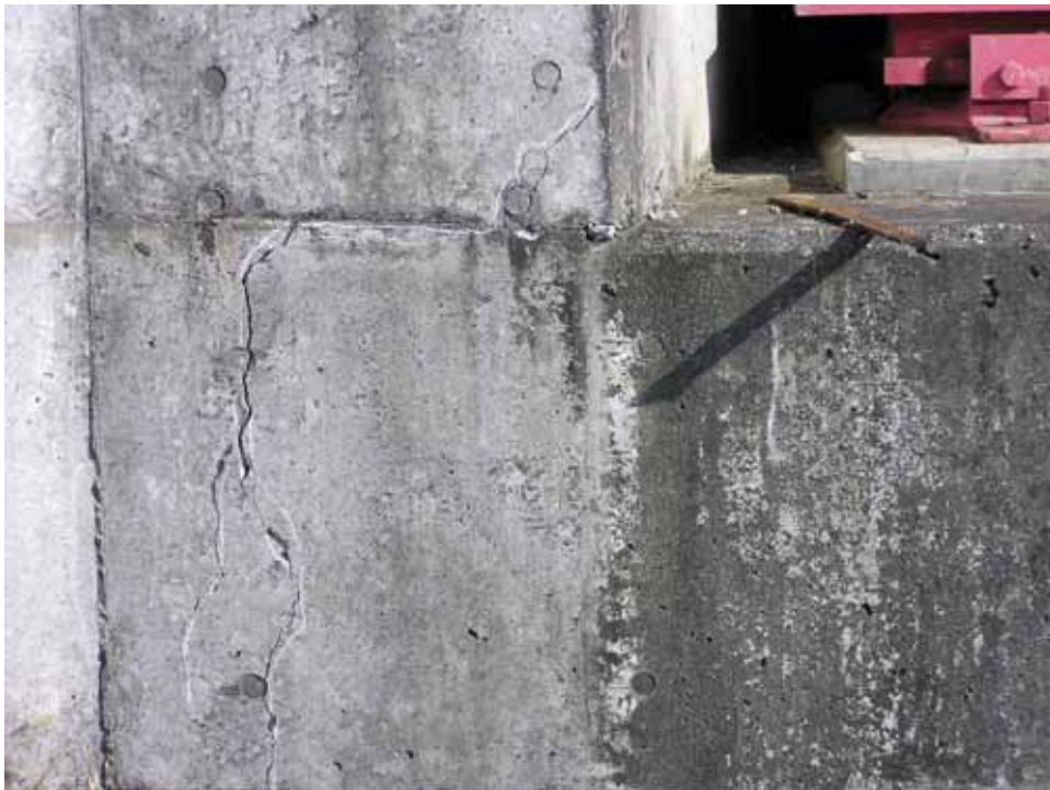
写真 - 2.86 橋台部の損傷(2) ( 2004 年 11 月 6 日 )
