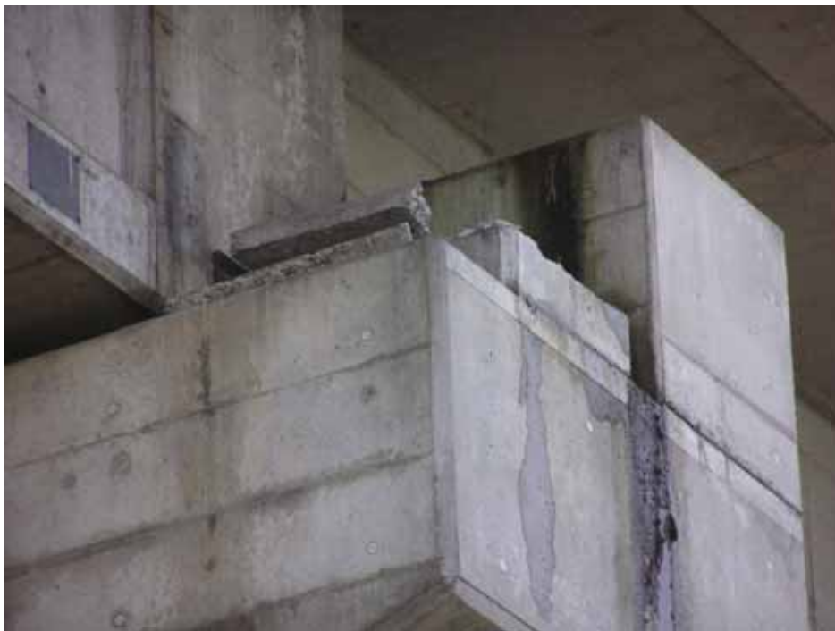
写真 - 2.7 上越新幹線高架橋 サイドブロックの損傷(1) (2004年11月7日)
