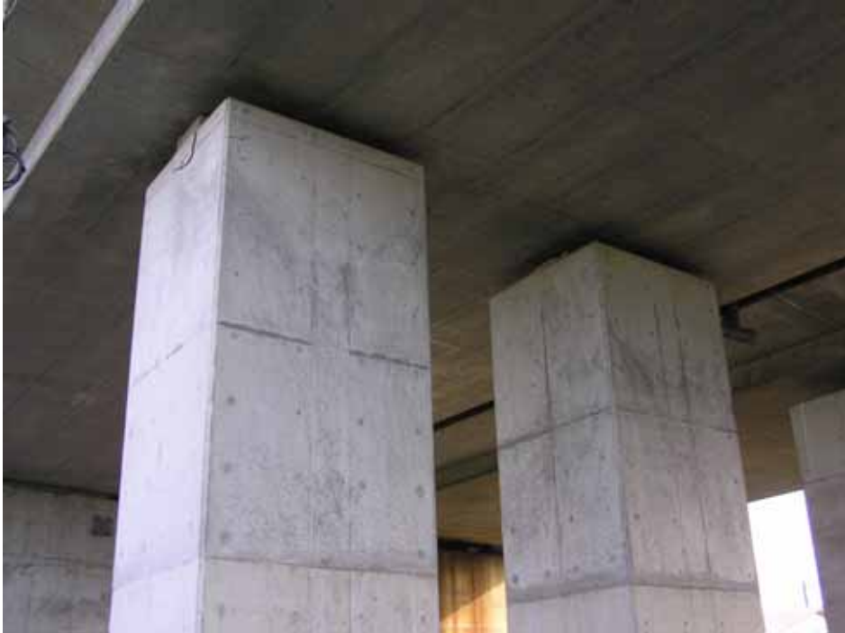
写真 - 2.11 支承部の損傷(1) (2004 年 11 月 7 日)
