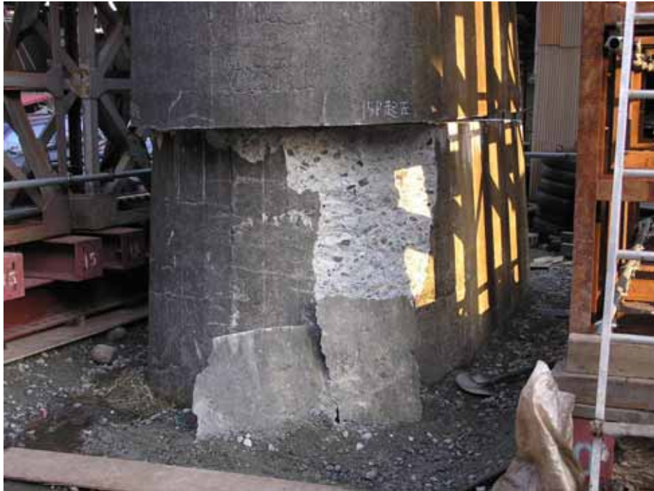
写真 - 2.39 魚野川橋梁の被害(3) (2004年11月7日)
