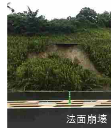
《法面危険箇所》
