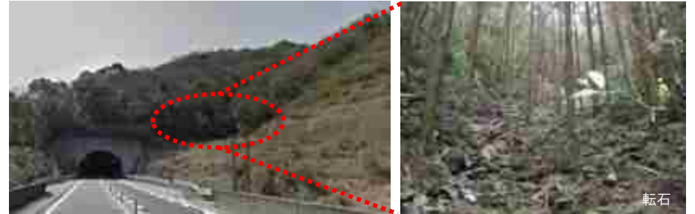
《法面危険箇所》
