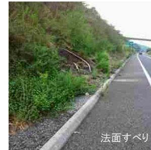
《法面危険箇所》
