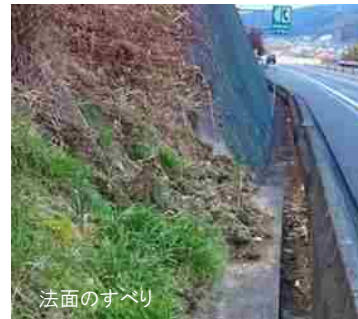
《法面危険箇所》
