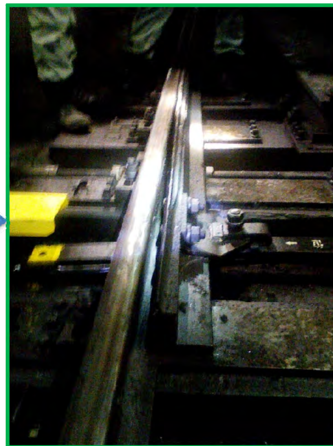
トングレール損傷状態
