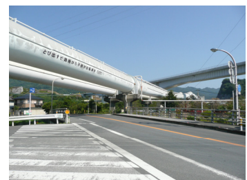
一般道路と交差するパイプライン
