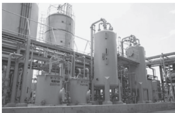
図 6.42 塩水 2 次精製工業装置の外観 (51)
