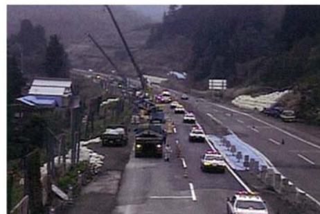
緊急車両の通行状況 (地震発生後100時間後)
