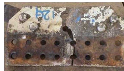
③ ガセットプレートの状況
