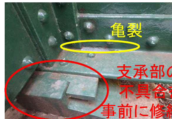
亀裂が発生した橋りょう
