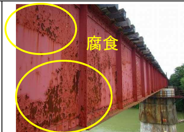
腐食が発生した橋りょう
