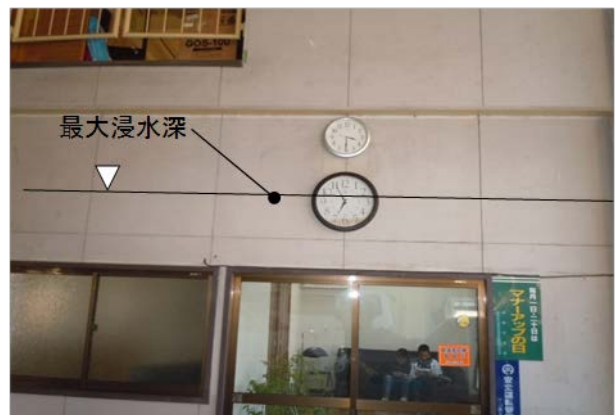
b) 拝田原地区(図 8.3③付近)の浸水状況(時計は浸水した時刻の 6:55AM で止まっている)
