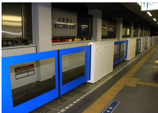
△船橋駅可動式ホーム柵
