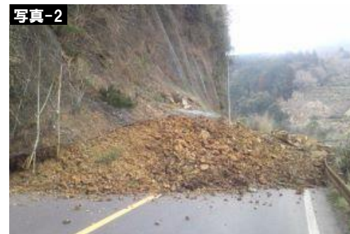
▲長門市俵山 (H24.2 被災状況)
