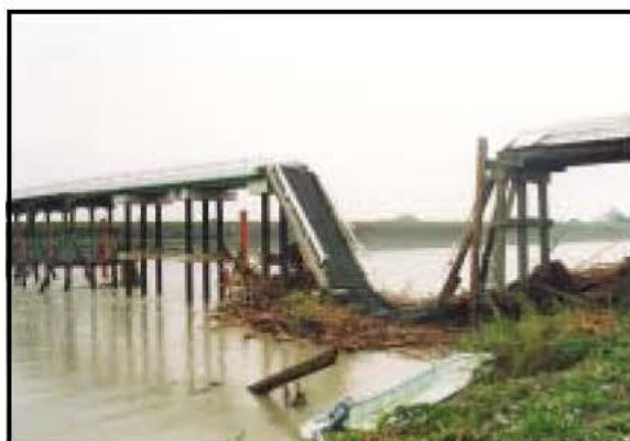
平成 9 年の出水により一部落橋した大平橋
