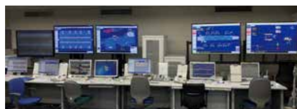
設備監視センター画面
