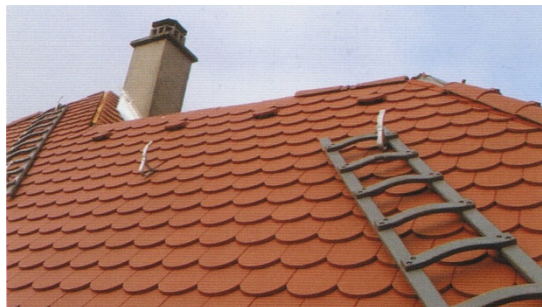
写真 6.5.2 屋根点検用金具を付けたドイツの住宅例（写真提供：岩元創）
