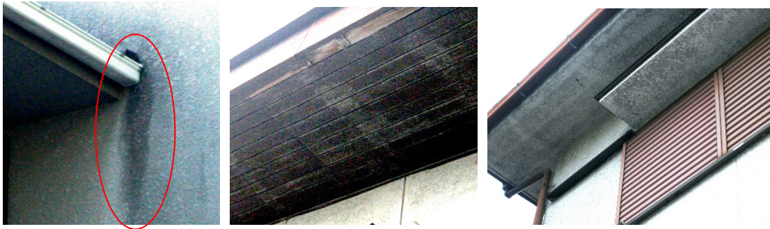
軒樋端部の雨垂れは要補修 軒裏の結露か雨漏れの兆候 軒天や庇裏に結露や漏水の疑い
