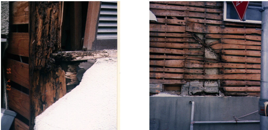
写真 1.1.1 阪神淡路大震災において見られたモルタル外壁被害と構造部材の腐朽・蟻害例
