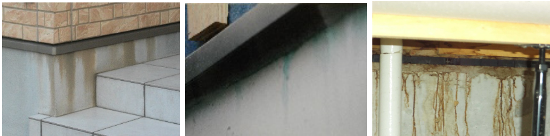
基礎の仕上げ面に雨垂れ状の汚れが付着している状態は床下内側の基礎にも見られます。
