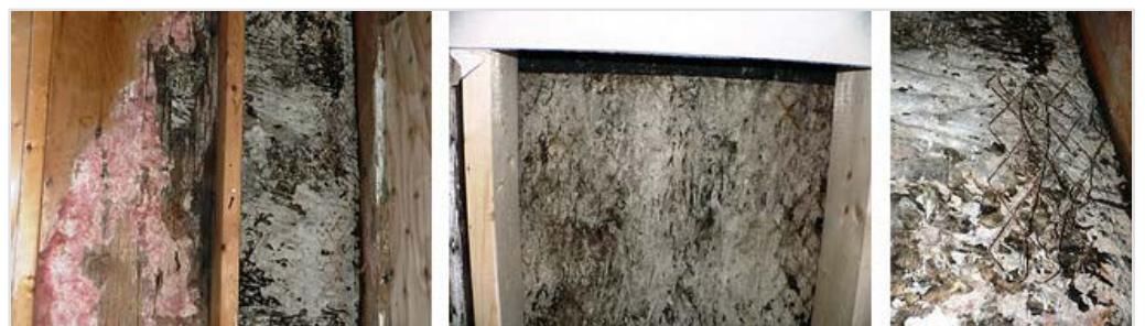
関東地方に建設されたモルタル直張り構法による築6年未満の合板耐力壁の状態 合板が腐朽して剥がれ、モルタルと腐食したプラスが露出している。
