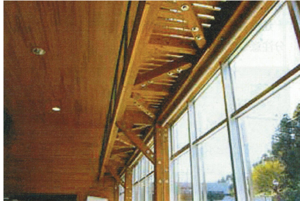
写真 6.5.1 メンテナンス用のキャットウォークの例（静岡県天竜区役所）
