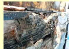
劣化したルーフバルコニー
