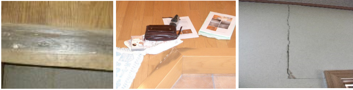
玄関の上がり框化粧面が変色、框の心材がシロアリの食害を受けていた。壁表面の罅割れは躯体変異が原因
