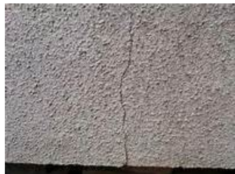
写真 3.2.8 モルタル外壁仕上げ面に生じたひび割れの例
