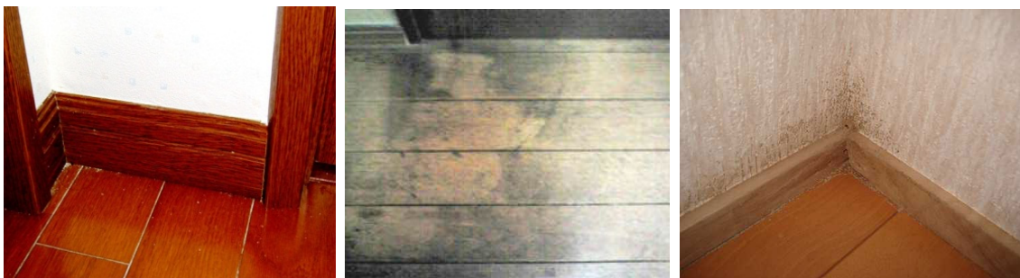
壁際の床に湿潤が発生した状態 床裏の結露により表面が黒く変色 壁の内部が湿潤し下部にカビが発生
