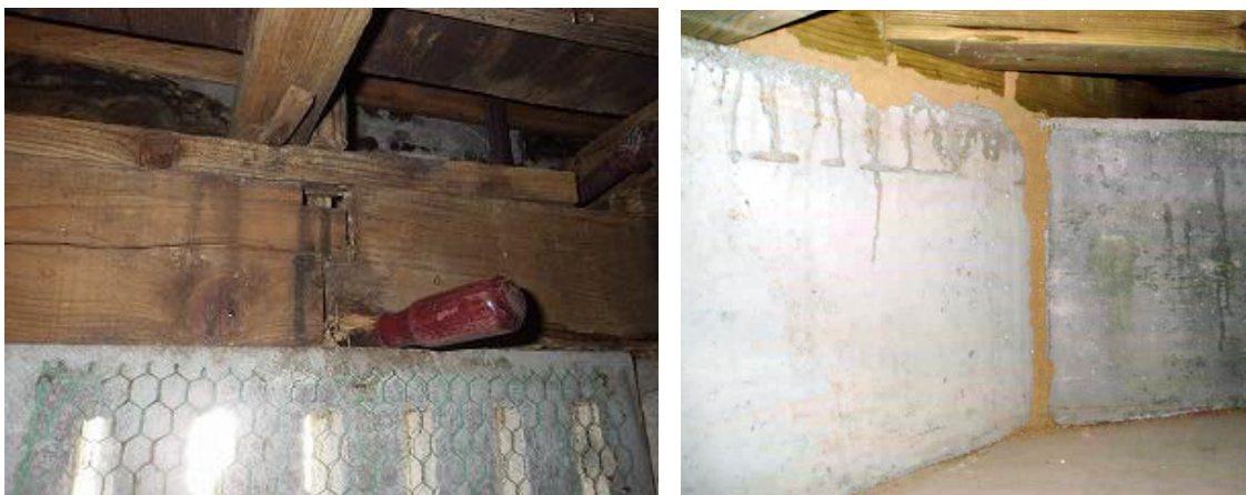
写真 6.3.3 左：土台下部の腐朽例 右：基礎立ち上がり部分に蟻道が構築され土台に達している例
