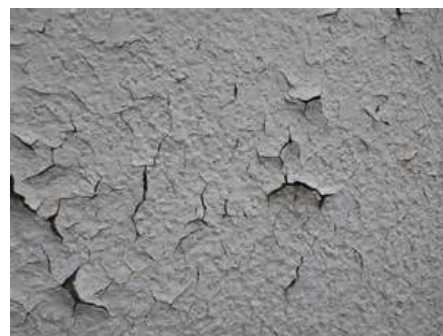
写真 3.2.6 モルタル外壁仕上げ塗材に生じたひび割れおよび剥離の例
