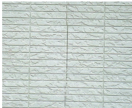
写真 3.2.3 シーリング材がサイディング材からはく離した状態（中央部） （出典：NYG 監修、不具合は何故起こるか、2009.6）
