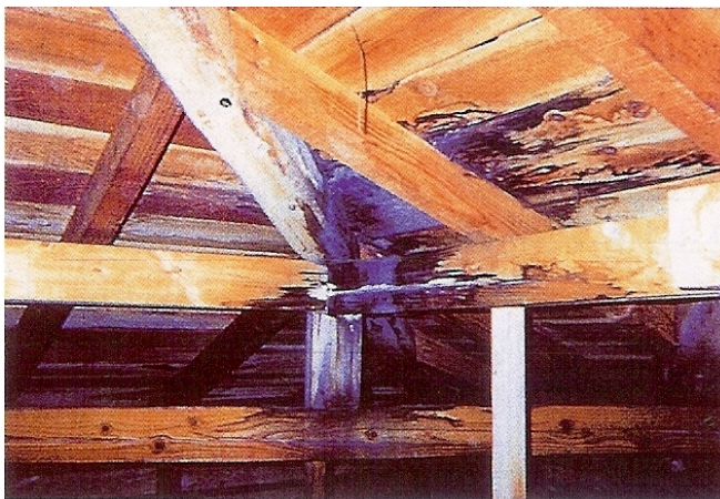
写真 6.3.8 小屋裏漏水箇所の様子
