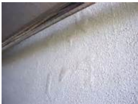
写真 3.2.5 モルタル外壁仕上げ塗材に生じた膨れの例
