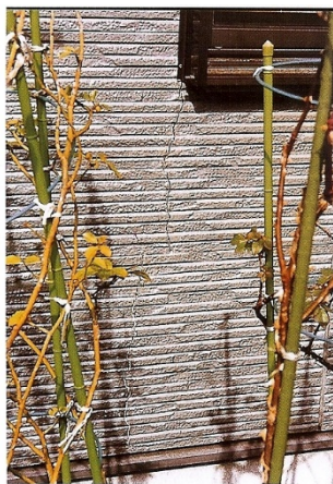
写真 6.3.5 サイディングの割れ
