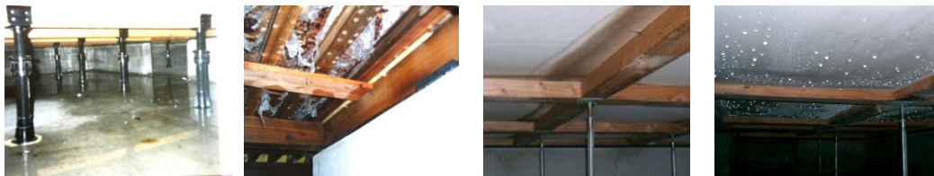
基礎打継からの浸水事例 床裏の木部湿潤事例 床裏断熱と木部の湿潤 床断熱材の結露と木部の湿潤
