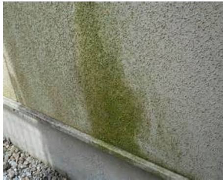
写真 3.2.4 モルタル外壁仕上げの藻による汚損例
