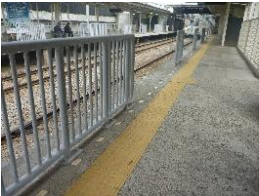
舞子公園駅固定式ホーム柵
