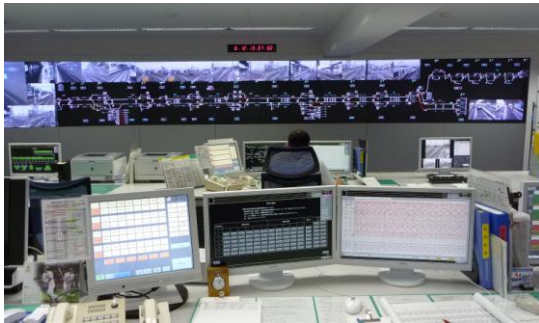
新運転指令室
