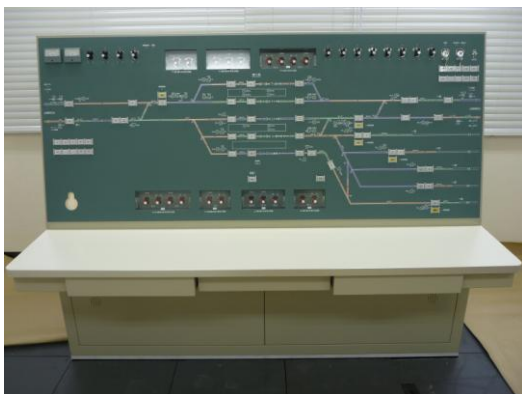
東二見信号扱所に搬入された新連動装置制御盤
