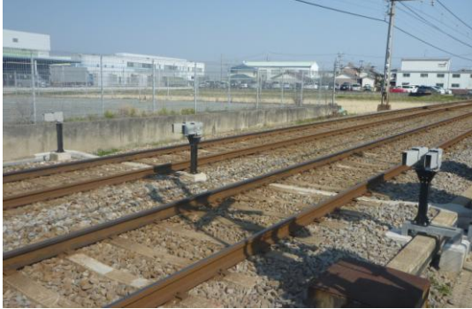
踏切支障検知装置
