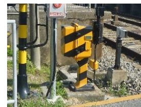
中八木踏切自動遮断機
