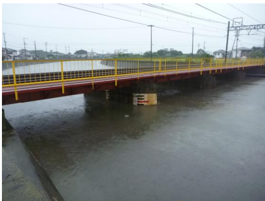
台風12号により増水した天川橋梁
