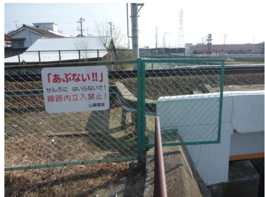
張り出し部分の増設と注意看板
