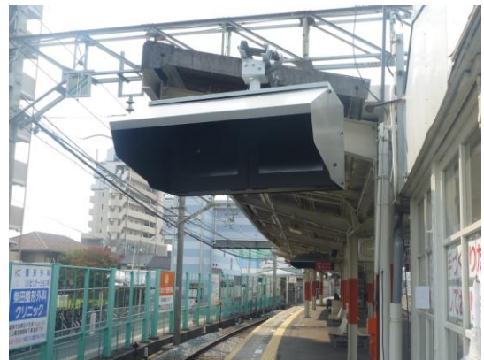
飾磨駅下りホーム乗降監視モニター
