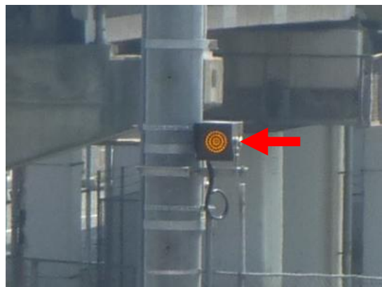
別府駅西方上り線列車接近警報装置
