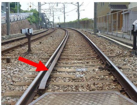
東垂水駅西方の脱線防止ガード
