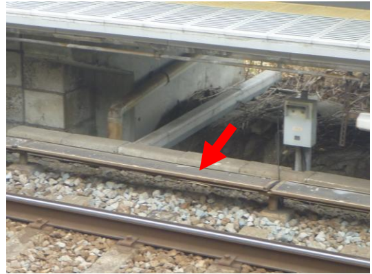
滝の茶屋駅ホーム転落検知装置
