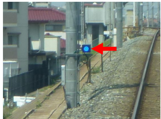
別府駅西方下り線列車接近警報装置
