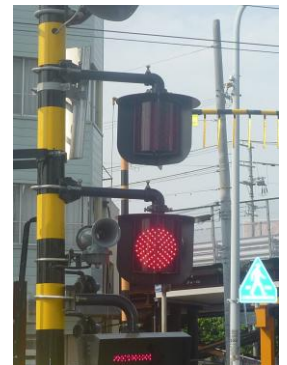
全方向踏切警報灯
