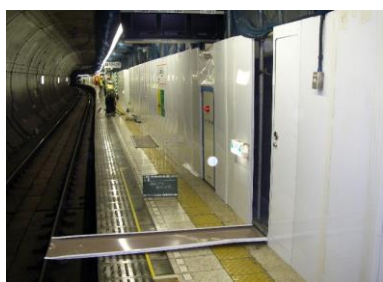
写真1 南行線ホーム 仮囲い鋼製パネル転倒状況 (推定)
