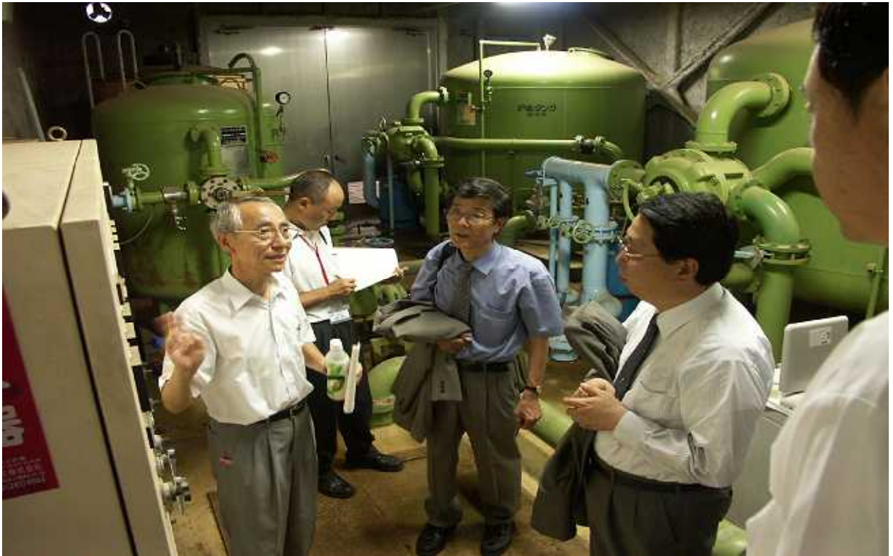
写真 大井プール施設内での確認【場所：機械室(1階)】
