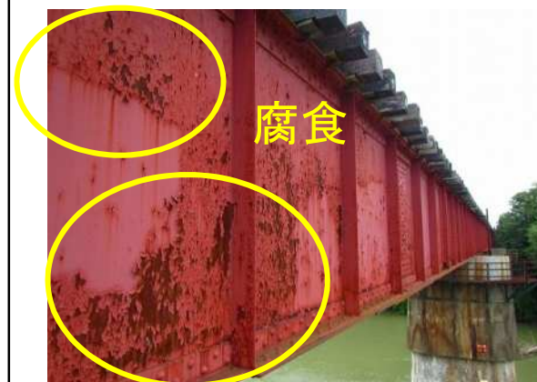
腐食が発生した橋りょう
