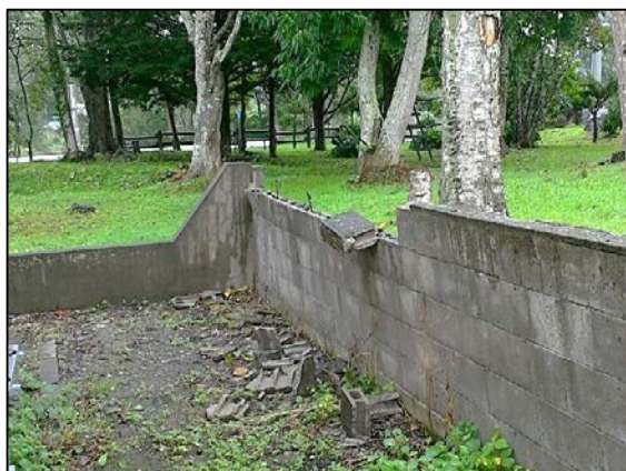
写真15 ブロック塀の崩れ
