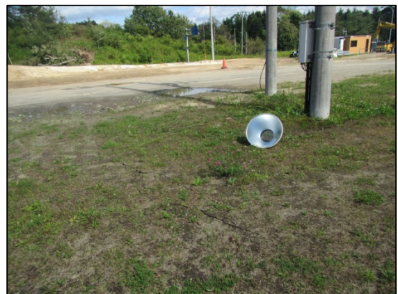
写真9 落下した照明
