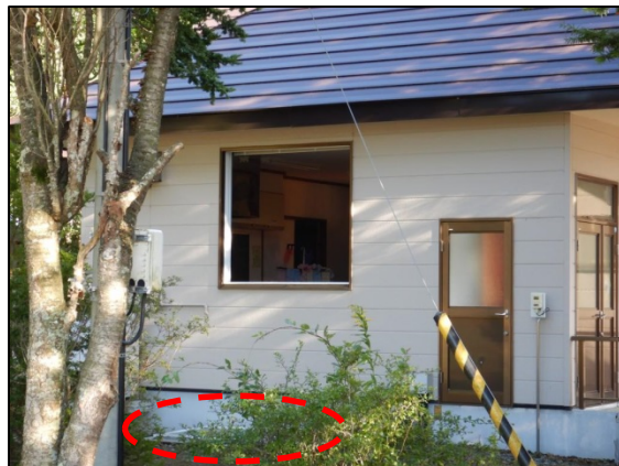
写真2 窓ガラスの落下 (赤破線部分に落下)
