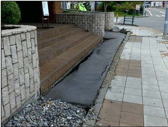
写真11 アスファルトの変形
