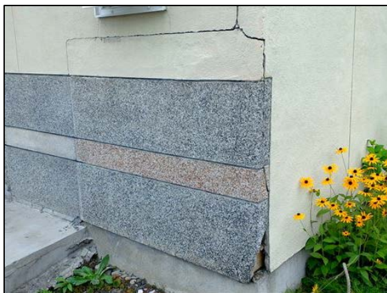
写真16 壁のひび割れ・剥離
