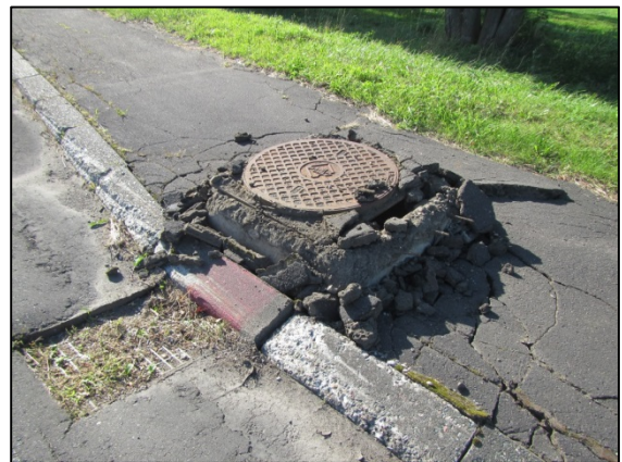
写真7 マンホールの浮上
