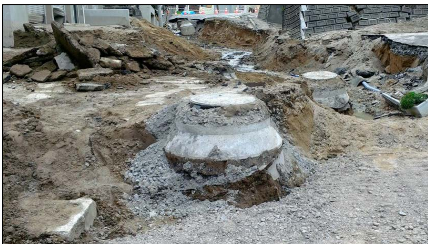
写真20 土砂流失による道路の破壊
