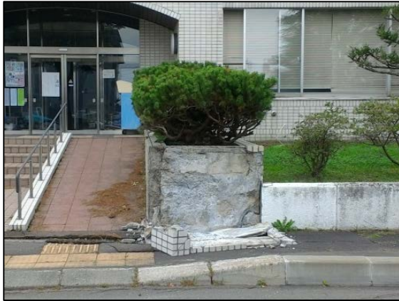
写真4 花壇土留めのタイル剥離
