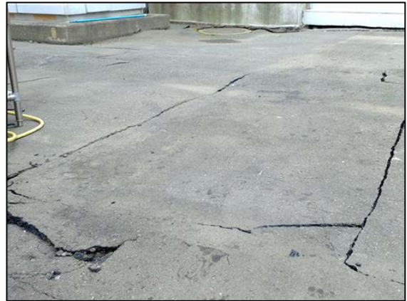
写真12 アスファルトの亀裂
