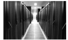
館林データセンター マシンルーム
