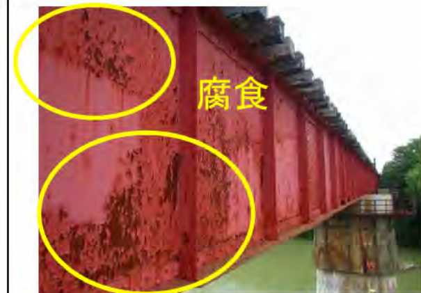
腐食が発生した橋りょう
