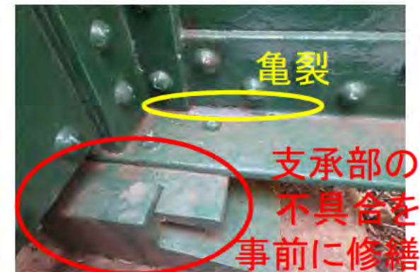
亀裂が発生した橋りょう
