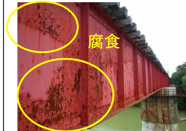
腐食が発生した橋りょう
