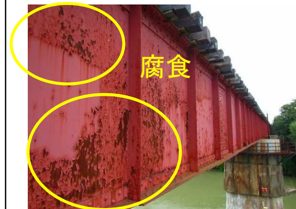
腐食が発生した橋りょう
