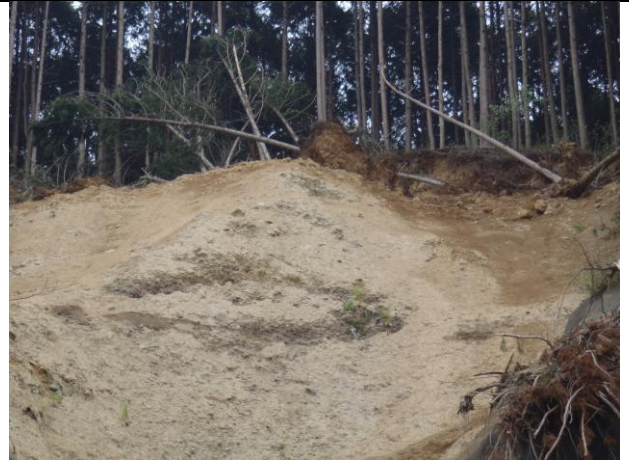
斜面上部の未固結層崩壊部
