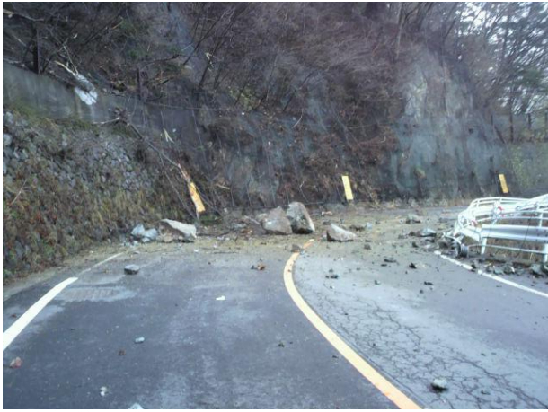
道路に点在する落石の状況
