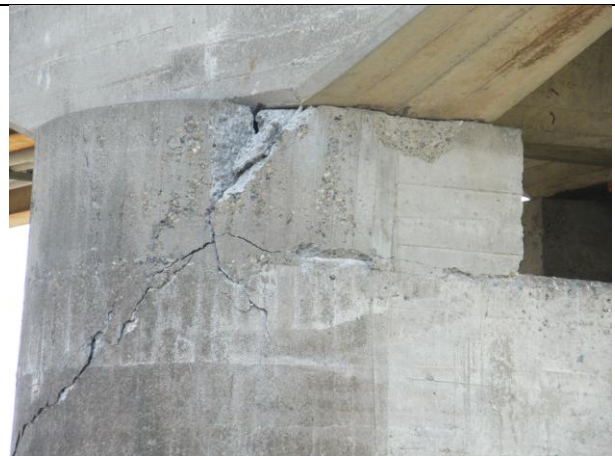
P4 橋脚のひび割れ
