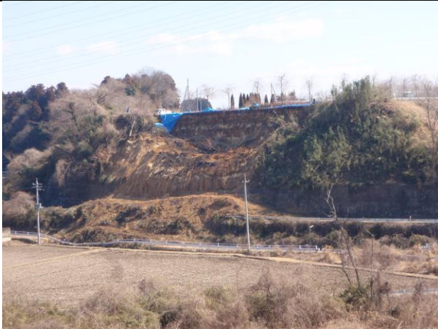
斜面崩壊遠景(その 2)
