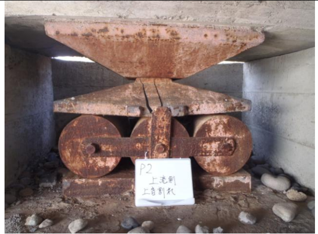
P2 橋脚鋼製支承の破断
