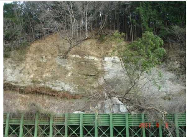
小口黒羽線の落石防護壁付近の崩壊部
