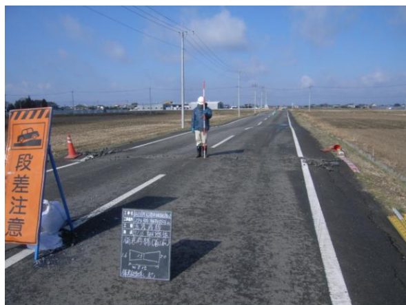
道路面の被害状況
