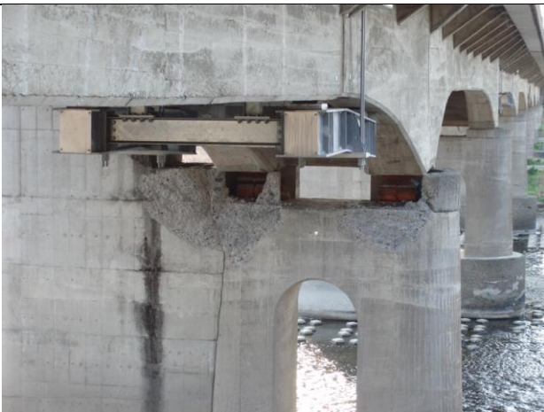
P2 橋脚沓座の破断
