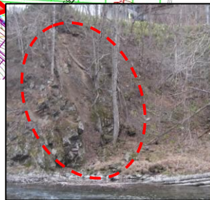
点検後の法面崩壊の状況
