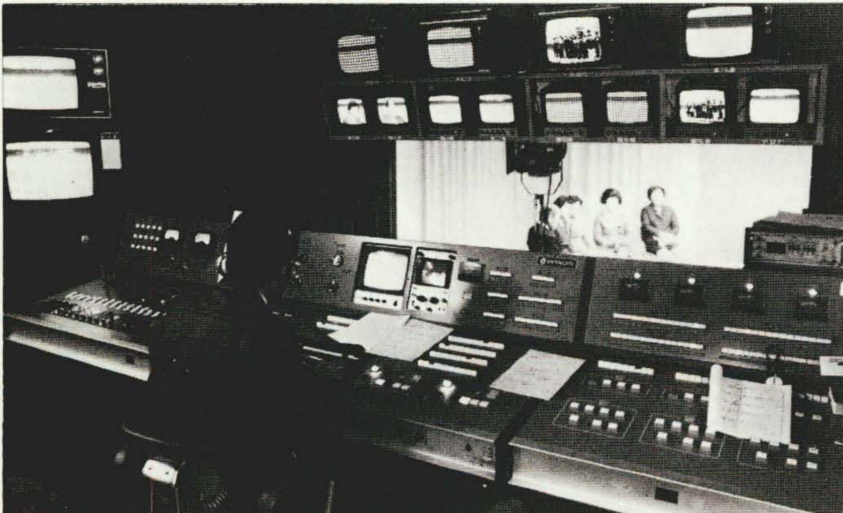
図7 館山市教育有線テレビジョン放送設備
