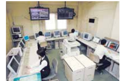
遠隔監視センター
