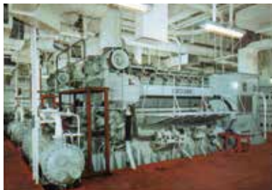
沖縄海洋博覧会「アクアポリス」(上)と設置された常用発電装置 12GL-UT × 1,500kVA × 2台
