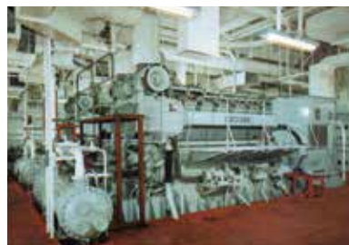
常用発電装置12GL-UT×1,500kVA
