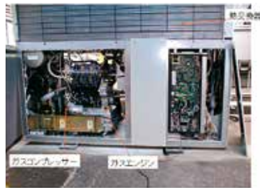
写真9 GHPエンジンの搭載状態
