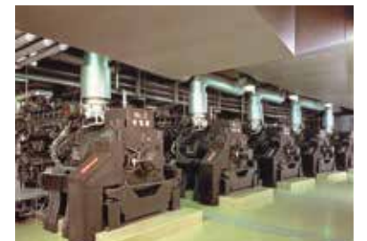
東京工科大学(上)へ納入した16SHLG-ST×625kVA×6台
