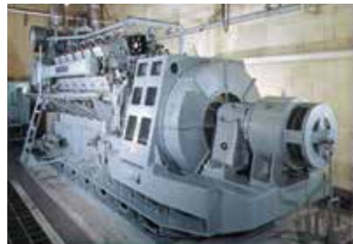
金融機関のデータセンター(上)と設置された非常用発電装置12GL-ST×2,000kVA
