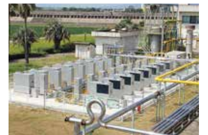
佐賀市下水浄化センターに設置された25kWのバイオガスマイクロコージェネシステム
