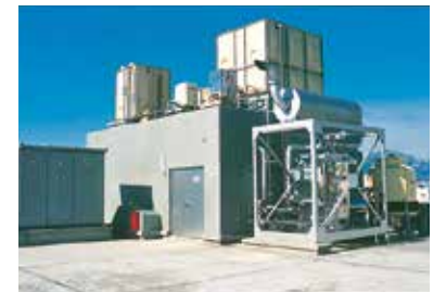
サウナ店に導入されたコージェネシステム (6HAL-HT × 160kVA × 2台)
