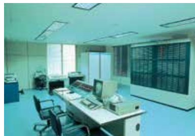
非常用発電装置の遠隔監視システム「GECONYS」
