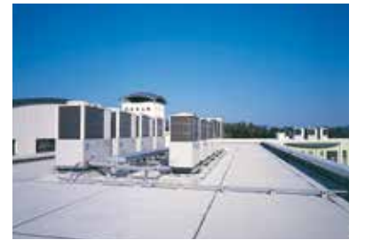
学校に設置された室内機(上)と室外機
