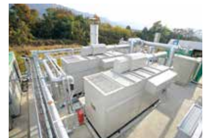
写真12 木質バイオマス・ガス化コージェネレーションシステム外観
