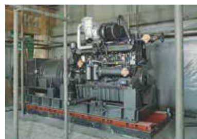
大和市下水道処理場(上)に設置された消化ガス発電装置の初号機6LAALG-DT×200kW
