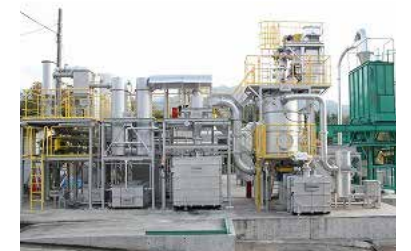
写真11 木質バイオマス・ガス化システム外観
