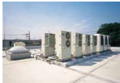
病院に設置された室内機(上)と室外機
