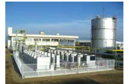
佐賀市下水浄化センターに16台設置されたCP25VB
