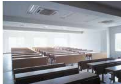
教室に設置された室内機
