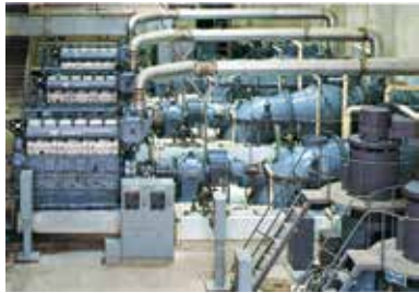
排水機場に設置されたポンプ用ディーゼルエンジン
