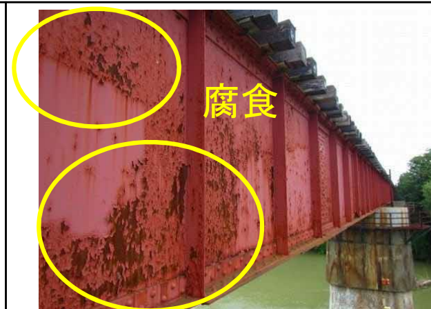
腐食が発生した橋りょう
