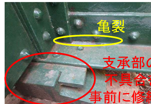
亀裂が発生した橋りょう
