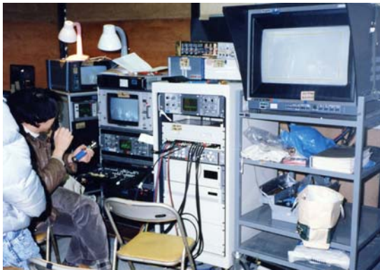
c: スタジオ外の仮設機器室
