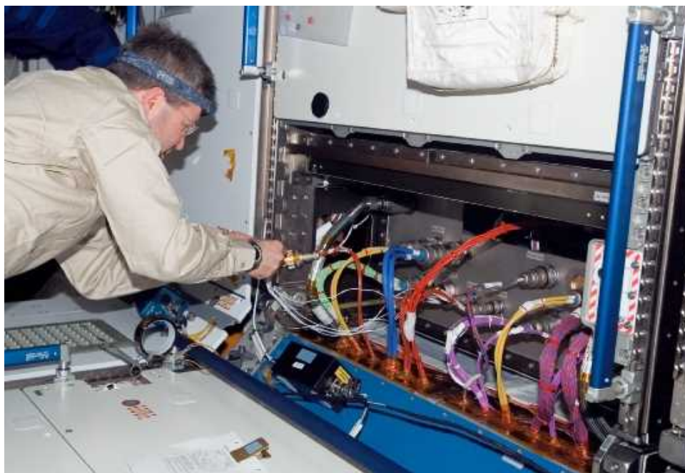
図3.4-4 ハーモニーの電力・通信配線のトラブルシューティング (故障箇所の究明) (NASA)
