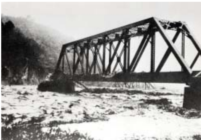
昭和9年7月洪水(天狗橋[県]流出状況)
