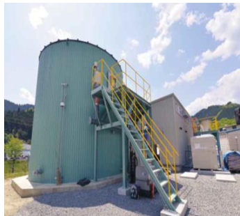
バイオ液肥・バイオガス実証プラント
