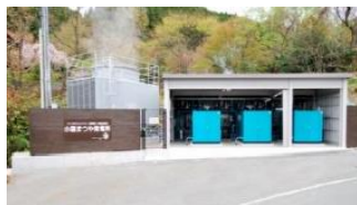
温泉旅館の源泉を活用した バイナリー発電所
