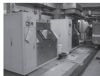
ホテル内に設置された大型生ごみ処理機
