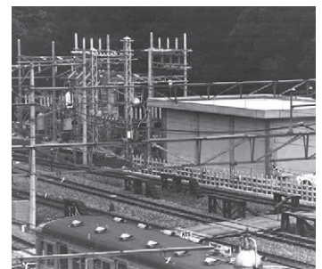
かしわ台変電所
