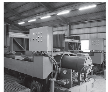
相武台採取所に設置した汚水処理施設
