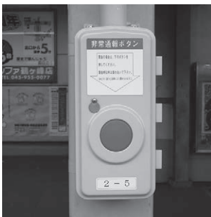
非常通報ボタン
