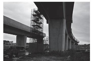
第3期区間建設工事(左の高架橋は一部区間で併走する横浜市営地下鉄)
