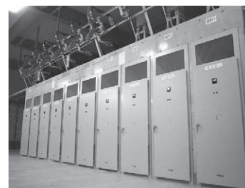
二俣川変電所の直流高速度遮断器
