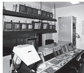
放送センター内の調整室
