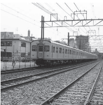
線路切り替えのため新しい線路(右)が敷設された大和駅地下化工事
