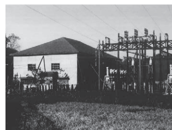
電力自給体制を確立した二俣川変電所
