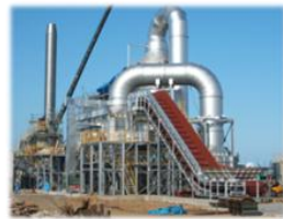
(仙台市設置仮設焼却炉)
