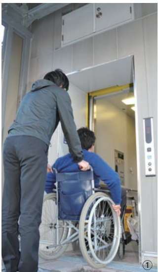
①設置されたエレベーター
