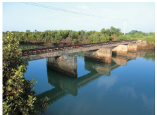
写真-29 ナンディ〜ラウトカ間を結ぶクイーンズ=ロード（幹線道路）と並行するサトウキビ鉄道のサンベト川に架かる5径間鉄筋コンクリート橋梁。(北西を見る。2014年2月24日)
