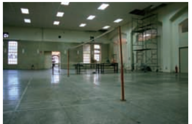
ここ数年は屋内運動場となっていた。天井は剥がれ落ち、無惨な姿である。
