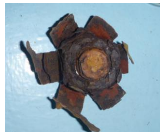
図-2 高力ボルトの腐食事例
