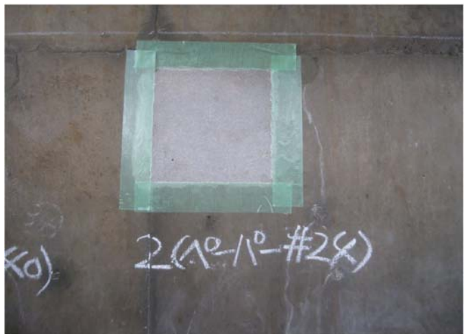
写真-2 橋脚梁部の変色 (P24 橋脚)
