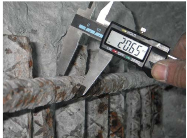
写真-3 橋脚梁部の鉄筋腐食状況
