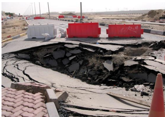
図-1 実際の Sinkhole 5)
