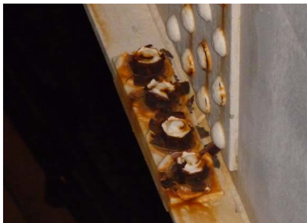
写真 1 添接部腐食状況
