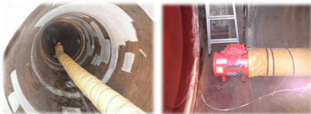
写真-4 放流管内の換気状況(防爆仕様機器)
