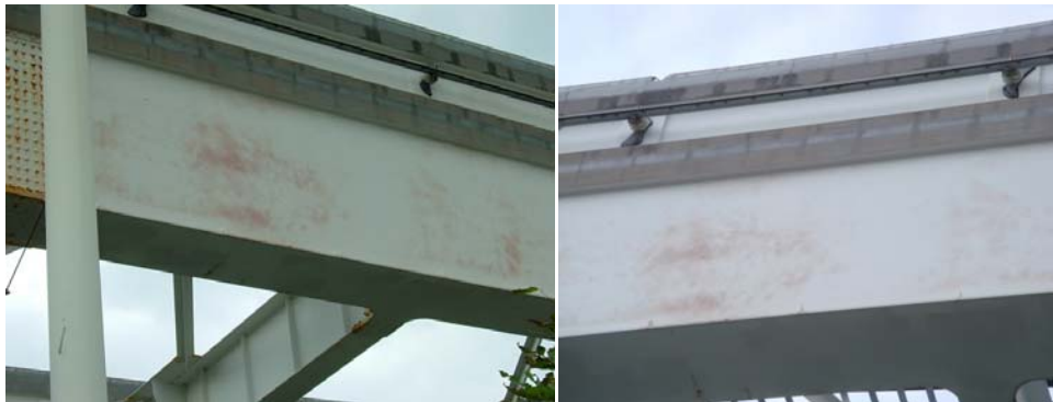
写真-5 沖縄都市モノレール桁の白亜化現象
