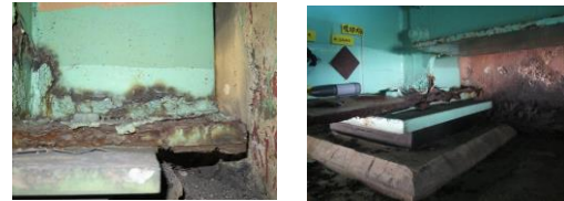
写真-1 桁端部が腐食した鋼橋
