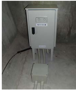
写真-5 P6橋脚に設置した子機
