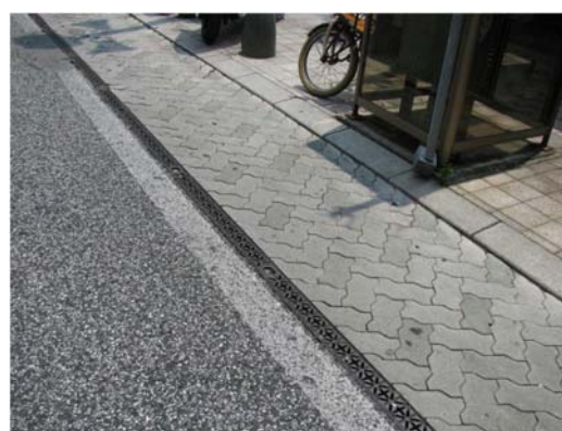
写真3 路肩のインターロッキングブロック
