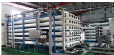
海水淡水化RO (Reverse Osmosis: 逆浸透) システム
