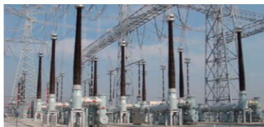
超々高電圧ガス絶縁開閉装置
